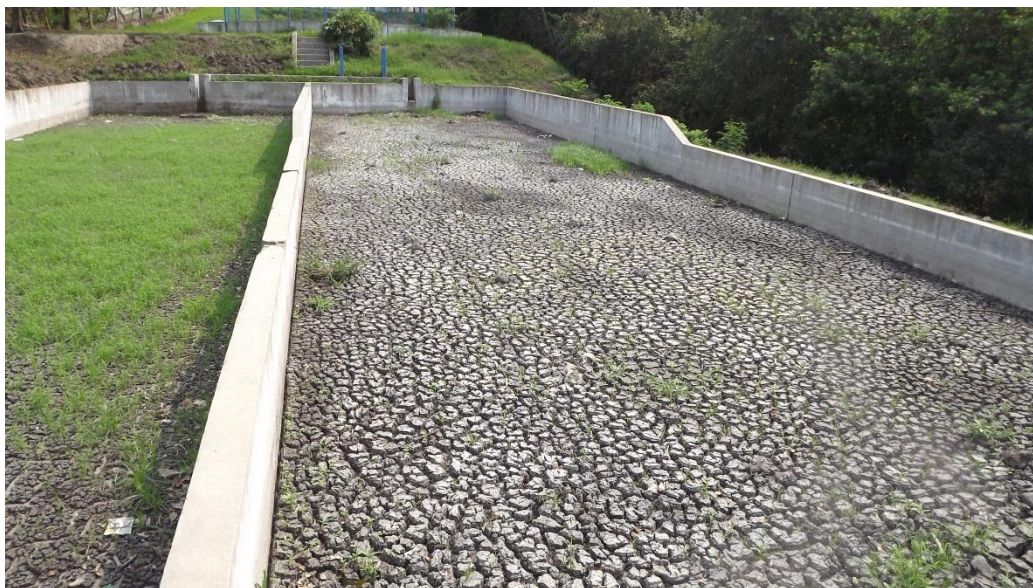
Anexo 20. Patios de secado de la PTAR de San Juan Talpa.
