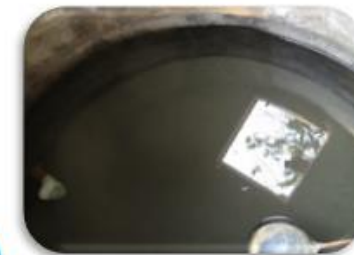
Filtro lento arena después de las mejoras
