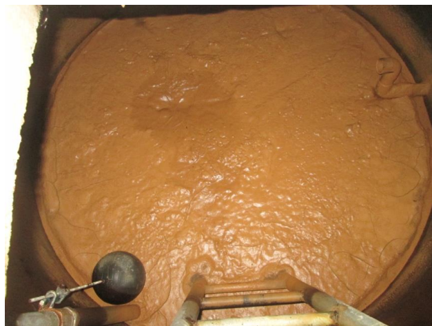
Figura 33. Filtro lento de arena sin mantenimiento.
