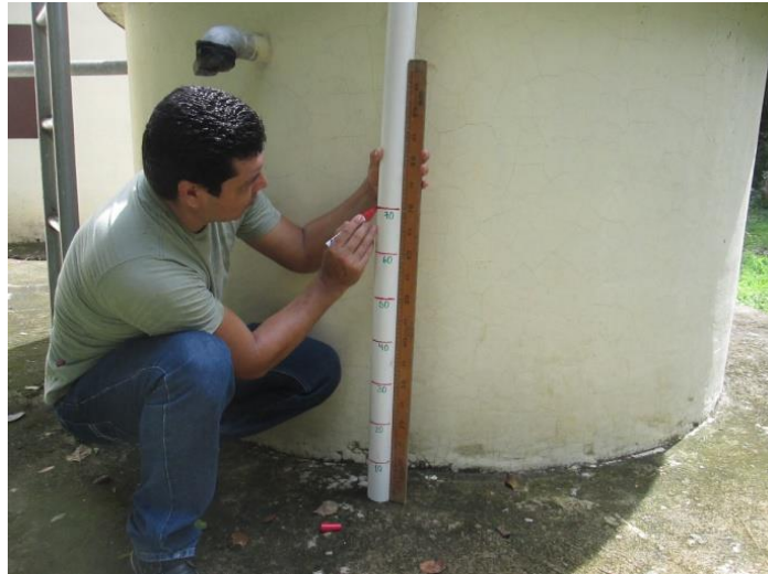
Figura 14. Graduación de tubo pvc para medir altura del agua en tanque.
