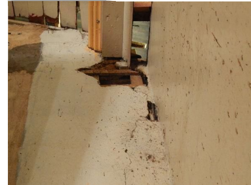
Fuente: Visita de campo Foto de cala, desprendimiento de pared.
