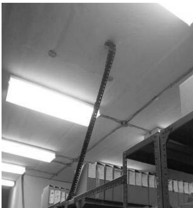
Ilustración A2.19 Norma de seguridad en que la que los estantes están asegurados al plafón del edificio
