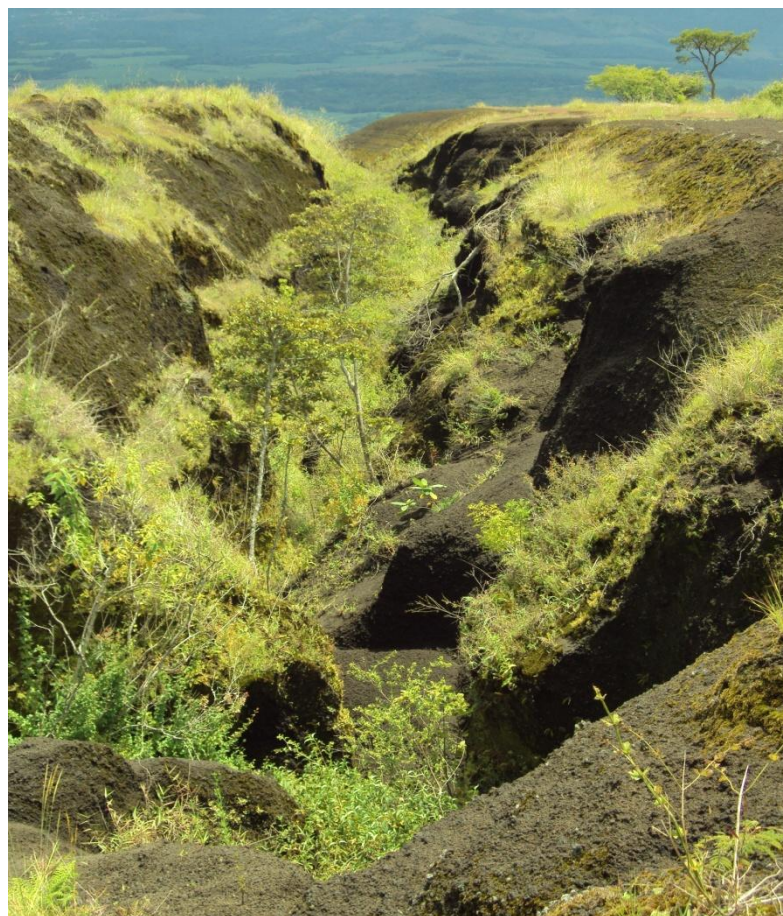
Fotografía No.12 Ampliación de cárcava durante la época lluviosa en el Cerro el Chino
