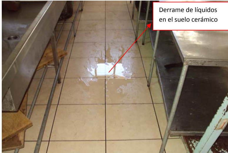
Imagen No. 1.1 Derrame de Liquido
