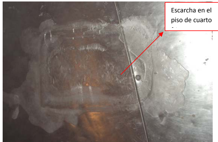
Imagen No.1.2 Escarcha en el piso del cuarto frío
