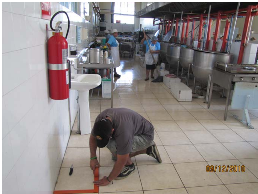
Imagen No. 5.5. Colocación y delimitación del área de los Extintores.
