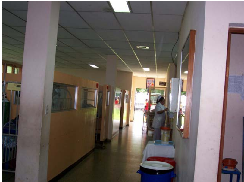
FOTO 44: LAMPARAS CON PROTECCION Y PAREDES DIVISORIAS DE TABLA YESO
