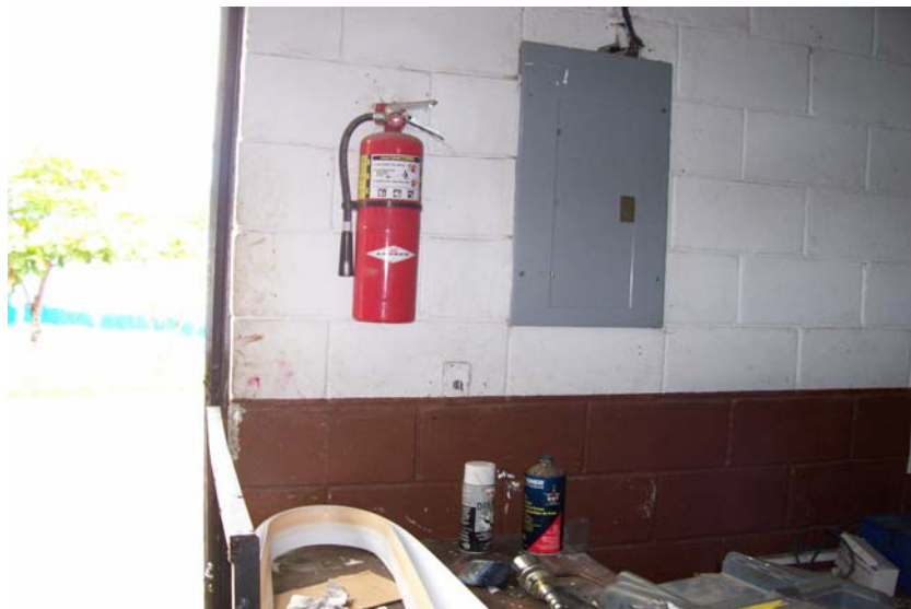
FOTO 48: EXTINTOR OBSTACULIZADO EN EL ÁREA DE MANTENIMIENTO.
