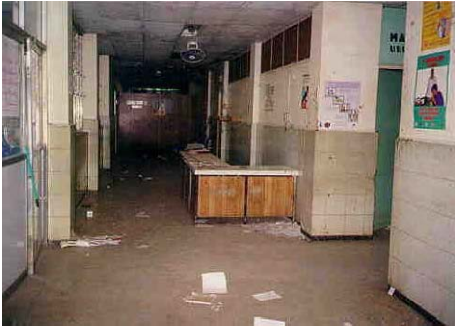
FOTO1. DAÑOS EN EL HOSPITAL NACIONAL SAN PEDRO DE USULUTAN A RAZ DEL TERREMOTO DEL 13 DE ENERO DEL 2001.
