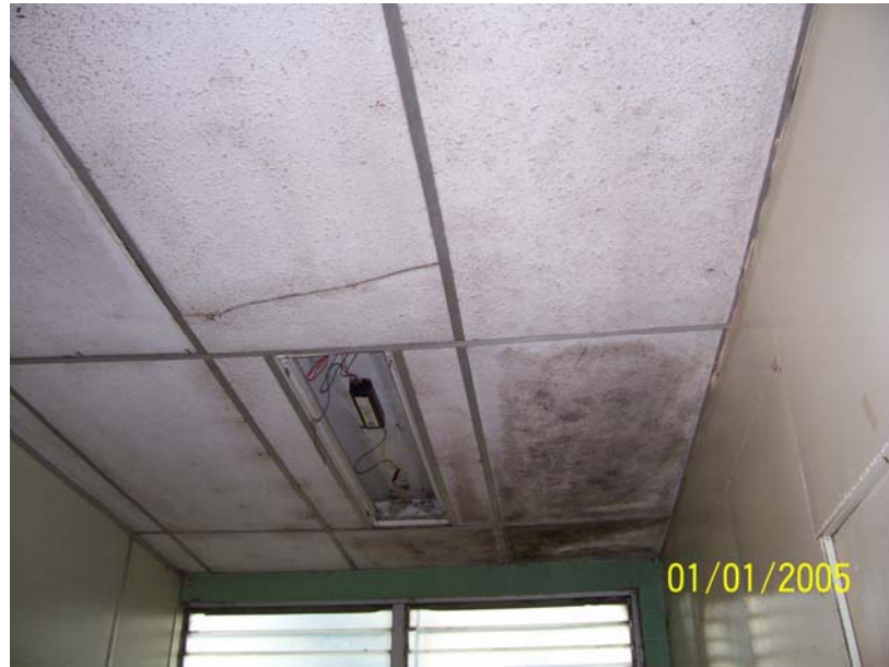
FOTO 16: DAÑOS EN EL CIELO FALSO
