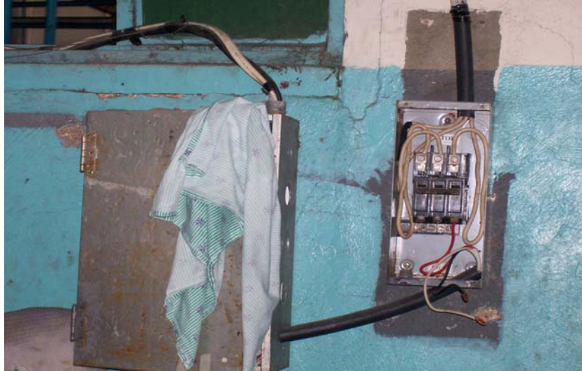
FOTO 33: CAJAS TERMICAS EN EL ÁREA DE LAVANDERIA.
