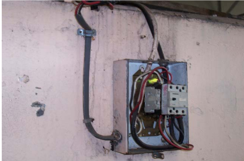
FOTO 35: CAJAS TÉRMICAS EN EL ÁREA DE COCINA.
