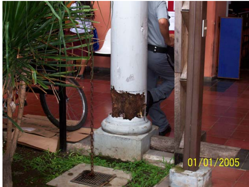
FOTO 73. COLUMNAS CON GRAVES DAÑOS EN EL EDIFICIO COLONIAL.
