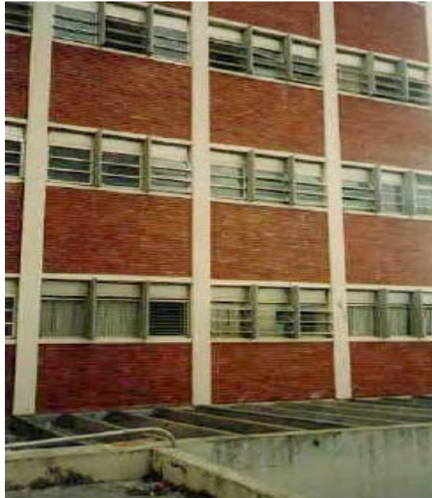
FOTO 3: HOSPITAL NACIONAL SAN PEDRO DE USULUTÁN. DAÑO ESTRUCTURALES LEVES A RAIZ DEL TERREMOTO DEL 13 DE FEBRERO DE 2001
