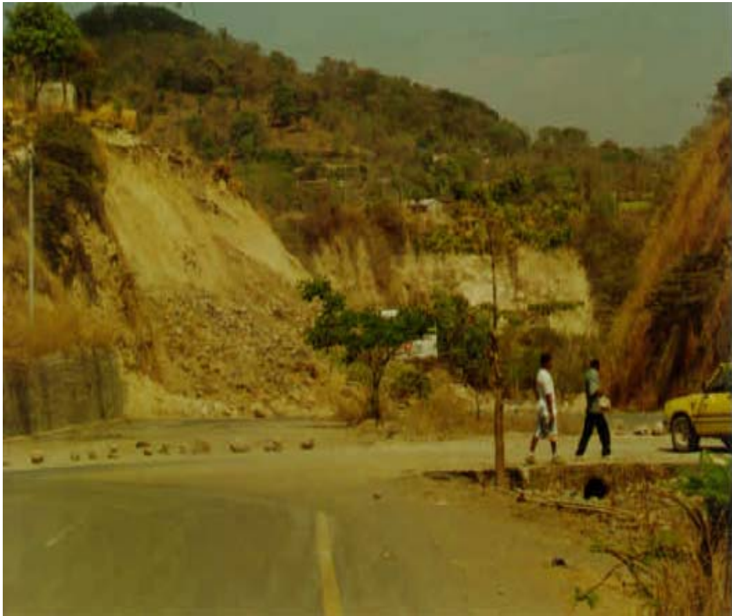
FOTO 6: DERRUMBE CARRETERO, CURVA LA LEONA. TERREMOTO DEL 13 DE FEBRERO DEL 2001.
