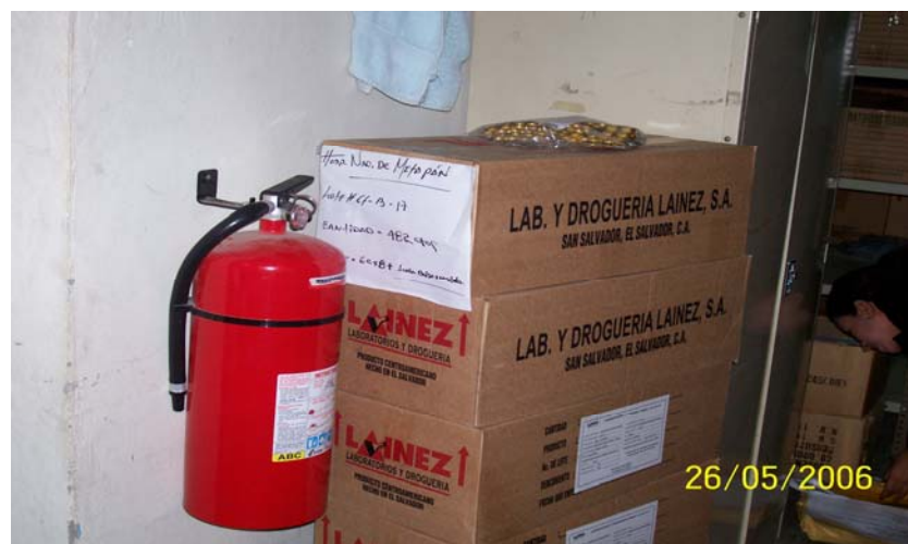
FOTO 21: EXTINTOR OBSTACULIZADO EN EL ÁREA DE ALMACEN.
