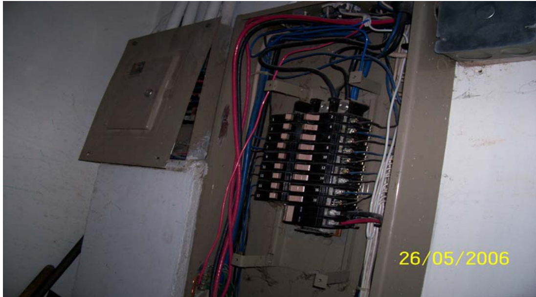
ANEXO 20: TABLEROS DESCUBIERTOS.
