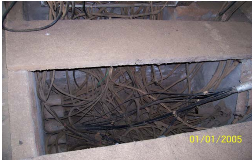
FOTO 63: ÁREA DE TRANSFERENCIA SIN CUBIERTA.
