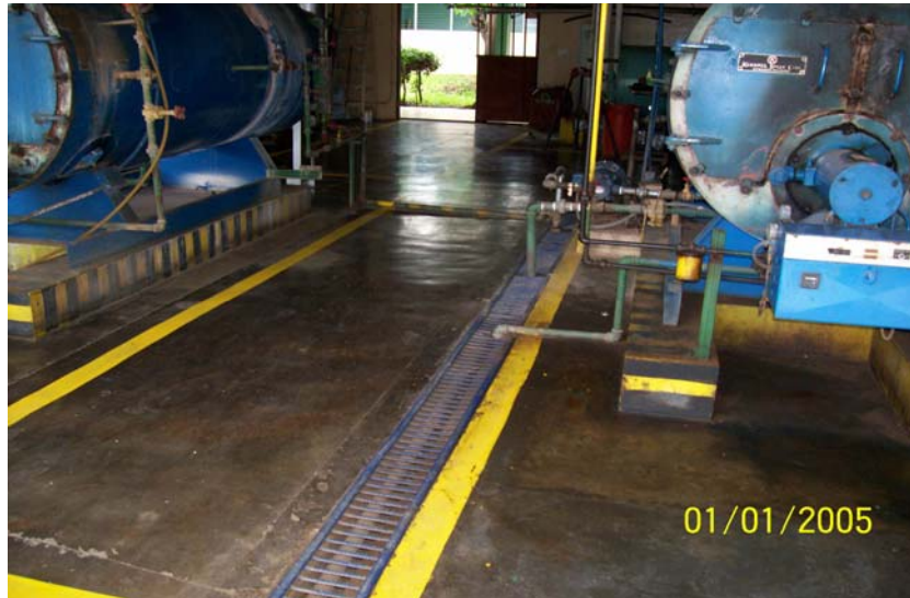
FOTO 58: SEÑALIZACIÓN EN EL PISO DE LAS ZONAS DE RIESGO EN CALDERA.
