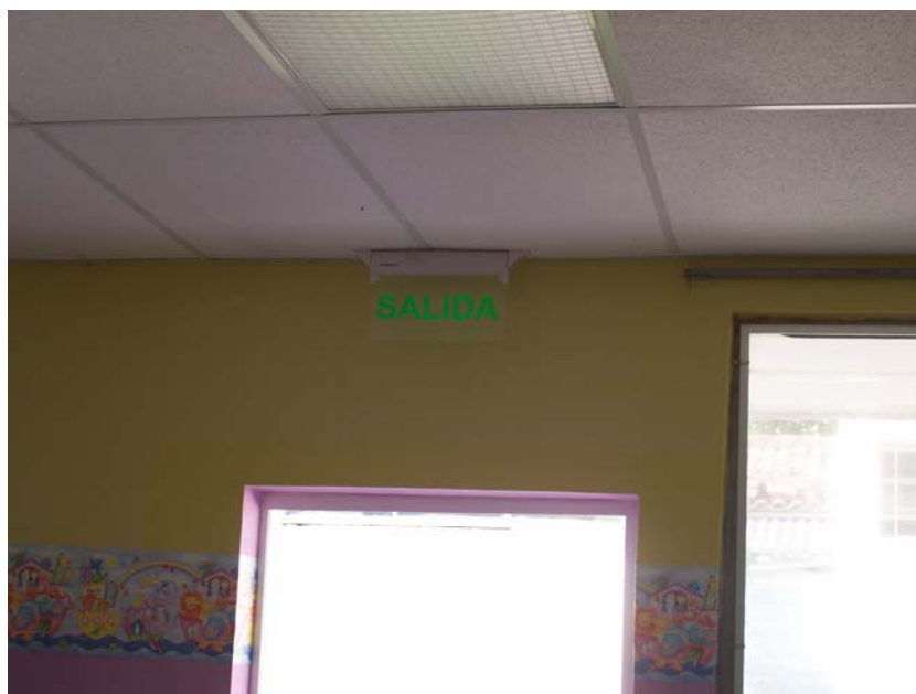
FOTO 37: SEÑALIZACIÓN DE SALIDA EN EL ÁREA DE ENCAMADOS DE PEDIATRIA
