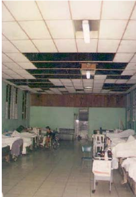
FOTO 5. HOSPITAL NACIONAL ROSALES. PABELLÓN DE HOSPITALIZACIÓN. DAÑOS EN PAREDES Y CIELOS FALSOS..
