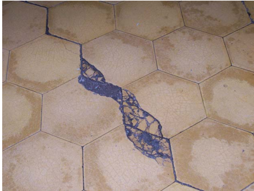
FOTO 29: DAÑOS EN EL PISO.
