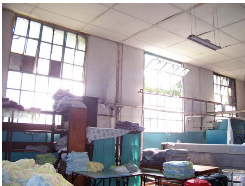
FOTO 32: TECHO FALSO DE MADERA, LÁMPARAS SIN PROTECCIÓN
