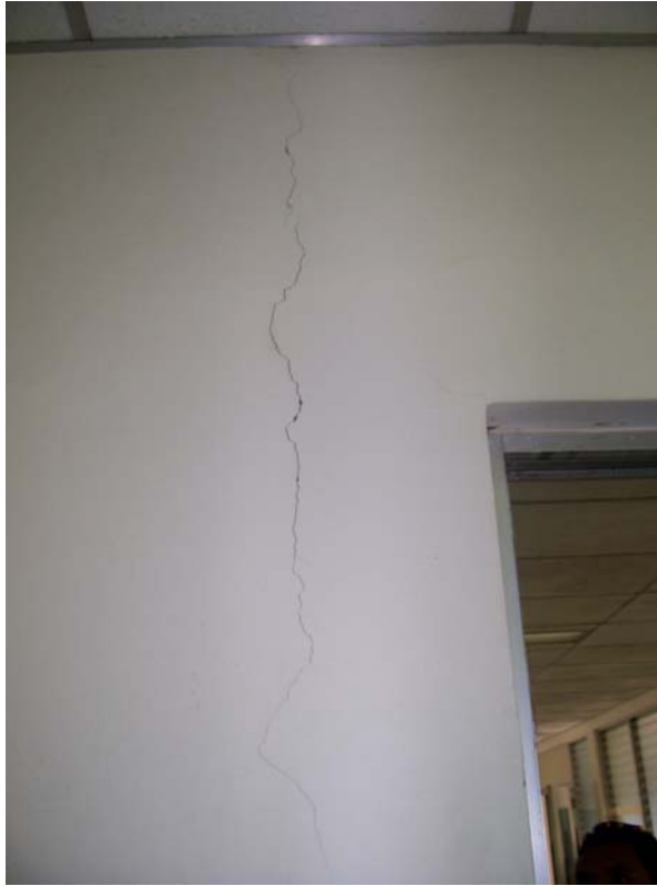
FOTO 18: PAREDES CON GRIETAS
