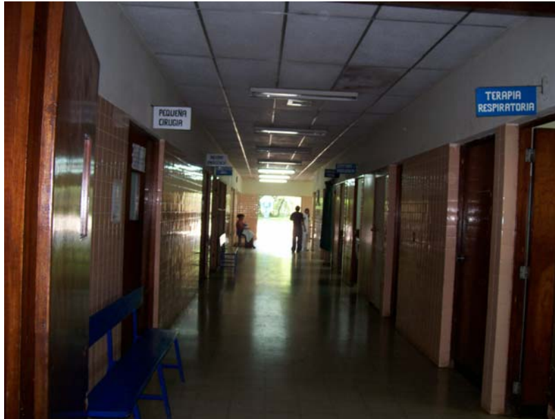
FOTO 41. LAMPARAS SIN PROTECCIÓN, CIELO FALSO EN MAL ESTADO.
