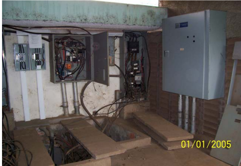
FOTO 62: ÁREA DE TRANSFERENCIA EN MALAS CONDICIONES.
