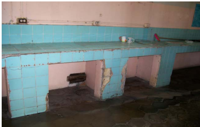
FOTO 34: TOMACORRIENTES EN MAL ESTADO EN EL ÁREA DE COCINA.
