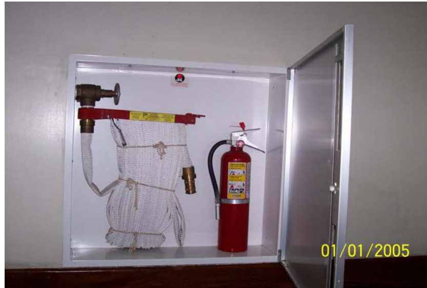
FOTO 75: GABINETES DE EXTINTORES Y MANGUERAS EN SONSONATE.
