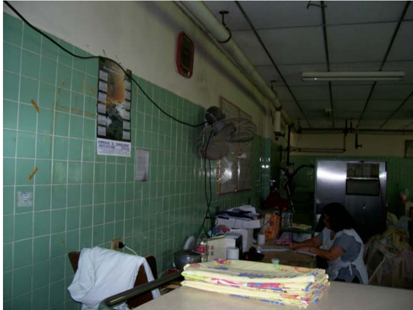
FOTO 47: TOMACORRIENTES CERCA DE MATERIALES INFLAMABLES.
