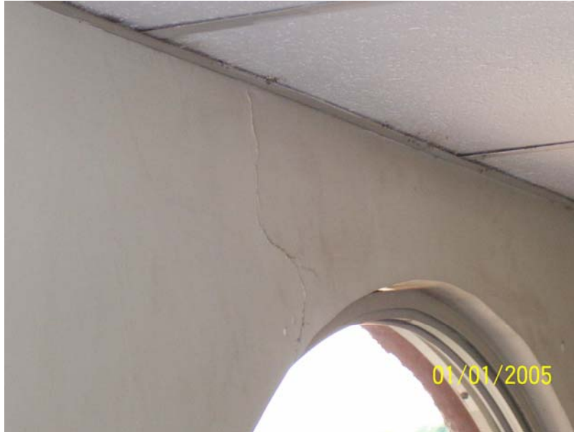
FOTO 71. PEQUEÑAS GRIETAS OBSERVADAS EN EL EDIFICIO CRITICO.
