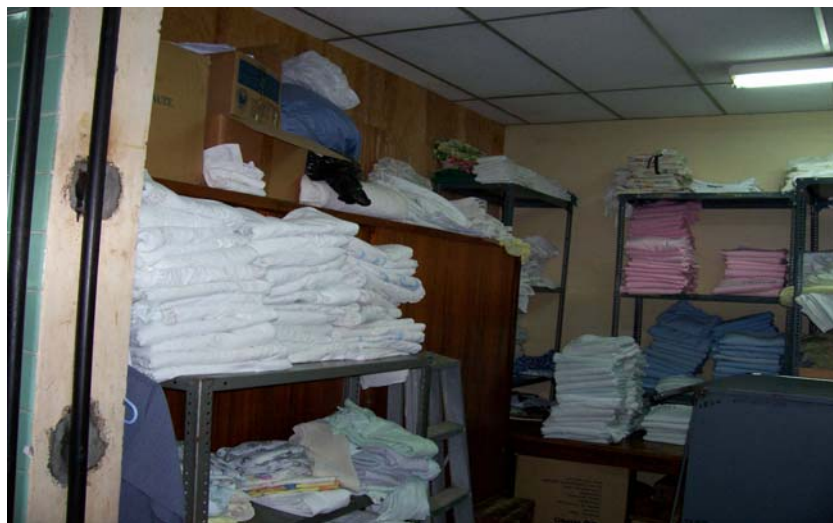
FOTO 46: ÁREA DE LAVANDERÍA, INTERRUPTORES OBSTACULIZADOS Y TOMACORRIENTES CERCA DE MATERIALES INFLAMABLES.
