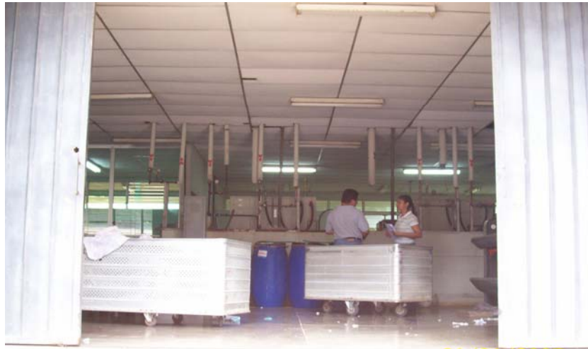
FOTO 56: TUBERÍAS SEÑALIZADAS EN EL ÀREA DE LAVANDERIA.
