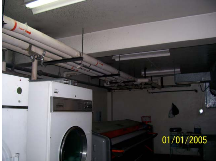
FOTO 77: SEÑALIZACIÓN DE TUBERÍAS EN ÁREA DE LAVANDERIA.
