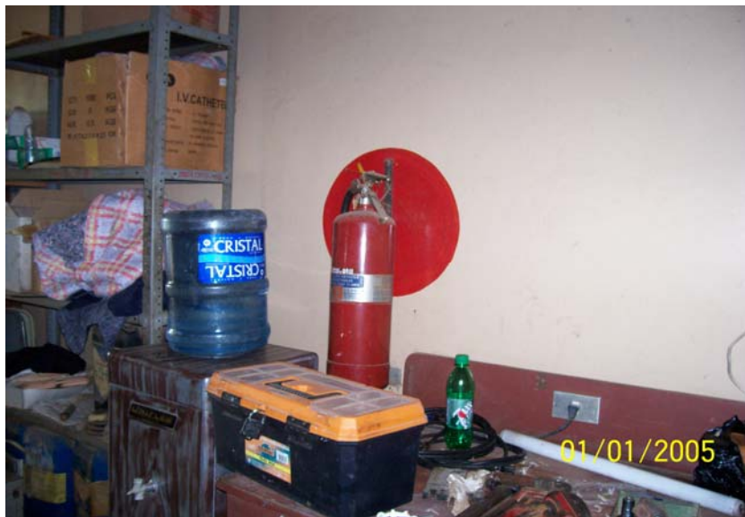
FOTO 57: EXTINTOR OBSTACULIZADO EN EL ÀREA DE MANTENIMIENTO
