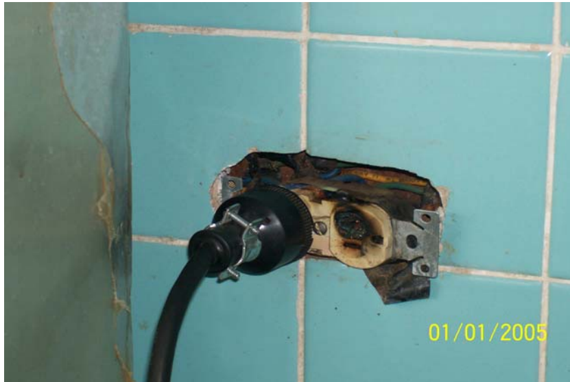
FOTO 61: TOMACORRIENTE EN MAL ESTADO EN EL ÁREA DE LAVANDERIA.
