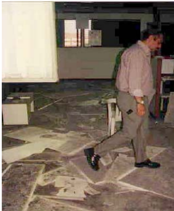
FOTO 4: HOSPITAL DE ONCOLOGÍA. DAÑOS NO ESTRUCTURALES SEVEROS EN EL ÚLTIMO PISO A RAIZ DEL TERREMOTO DEL 13 DE FEBRERO DE 2001
