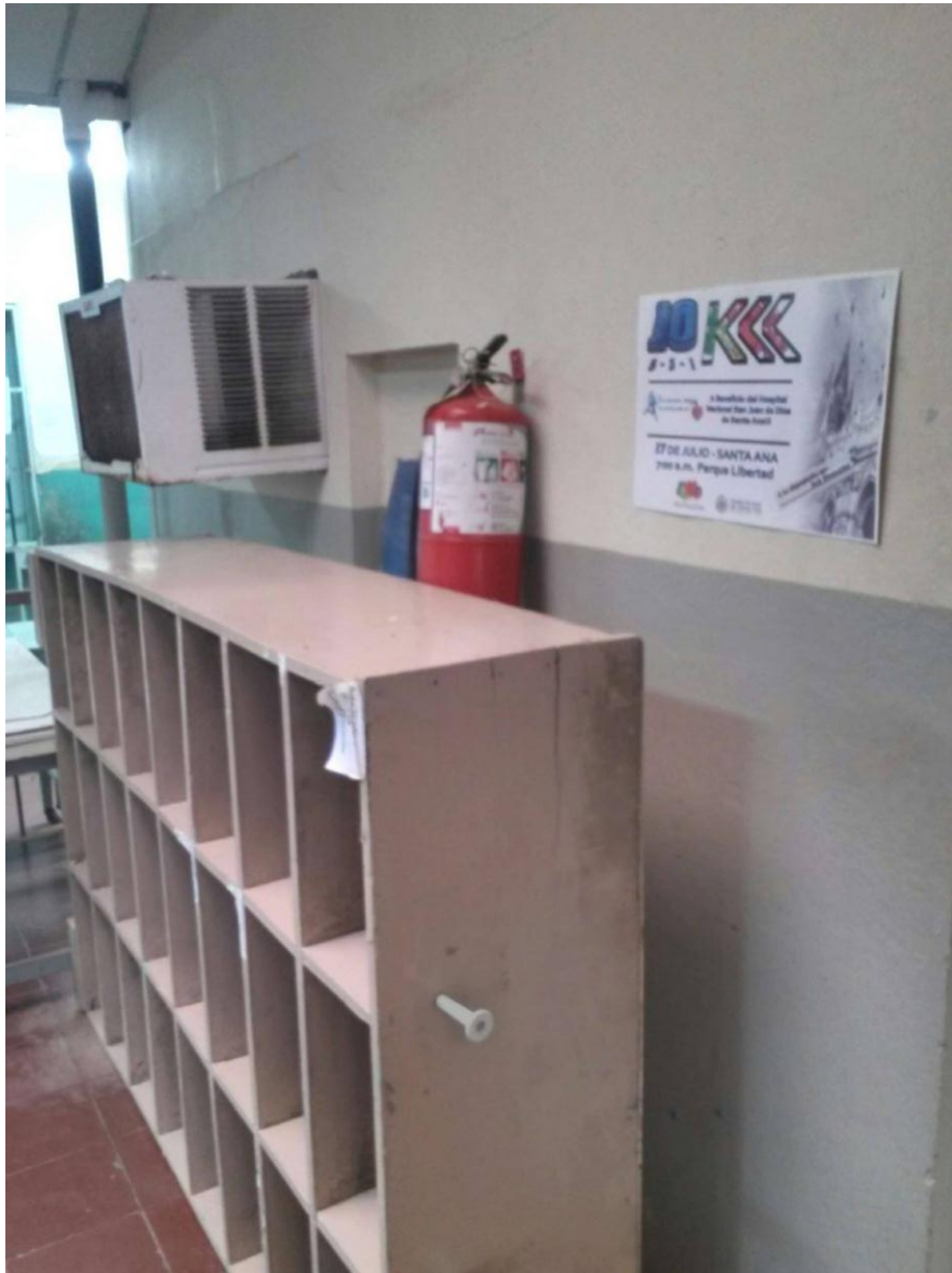
Imagen 7: extintores obstruidos, unidad de consulta externa, área 2
