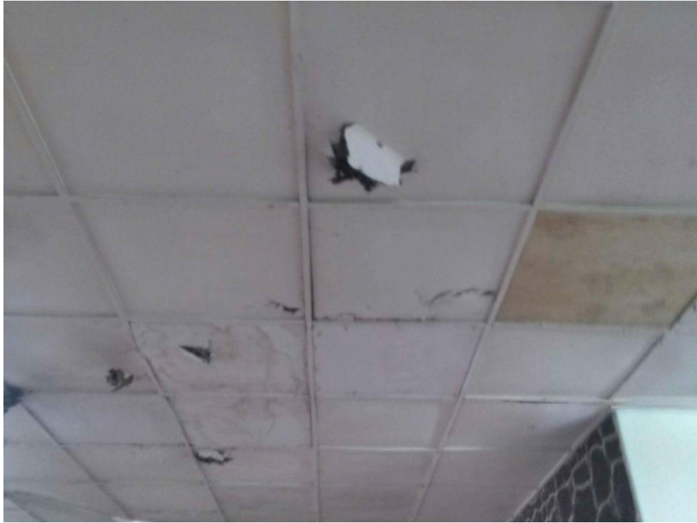
Imagen 3: Techo dañado sin reparar, unidad de consulta externa, área 2
