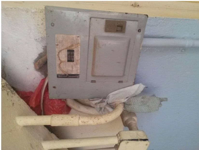
Imagen 6: Tableros eléctricos sin señalización, unidad de consulta externa, área 5
