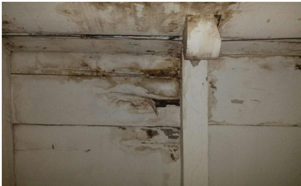
Imagen 2: Techo de madera, presenta filtración de agua, unidad de consulta externa, área 4
