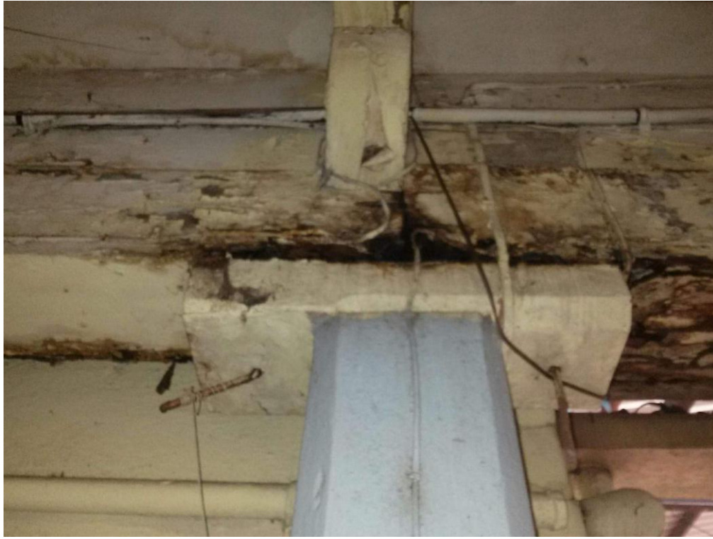
Imagen 5: Vigas con señales de filtración de agua, unidad de consulta externa, área 4
