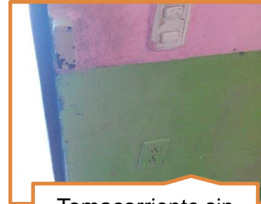
Tomacorriente sin proteccion en kinder
