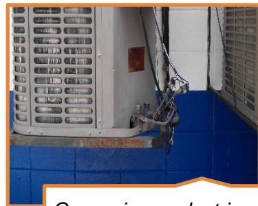
Coneccciones electricas en exteriores
