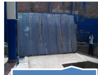
Muros de edificaciones antiguas y agrietadas.
