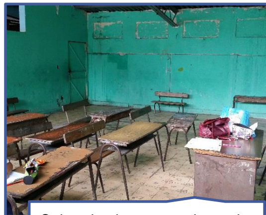
Salon de clase en mal estado.
