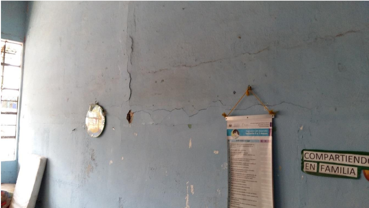
Ilustración 39: Pared dañada en el área de educación inicial, específicamente en lúdica.
