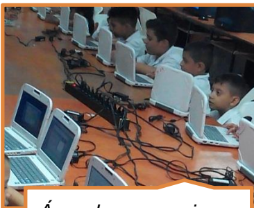
Área de coneccciones electricas en salones
