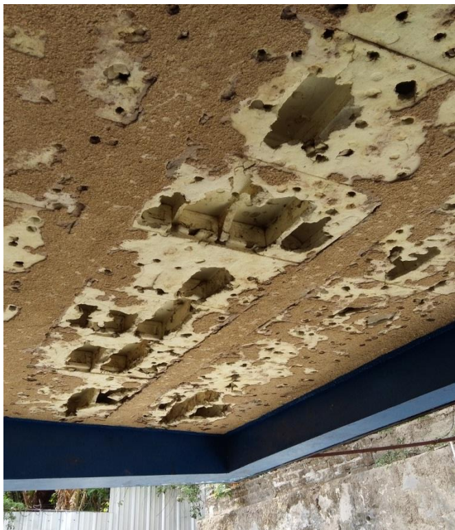
Ilustración 21. Daño en el cielo falso de edificio principal
