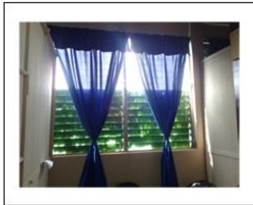
Figura 3.67. Problema iluminación natural: Ventanas pintadas en departamento de Ciencias Económicas. Fuente: Propia.
