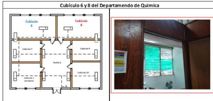
Figura 3.66. Problema iluminación natural: Ventanas pintadas en cubículos 6 y 8, depto. de Química. Fuente: Propia.
