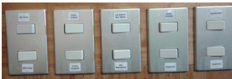
Figura 3.95. Rotulación de los apagadores de luminarias en el departamento de Matemática.
