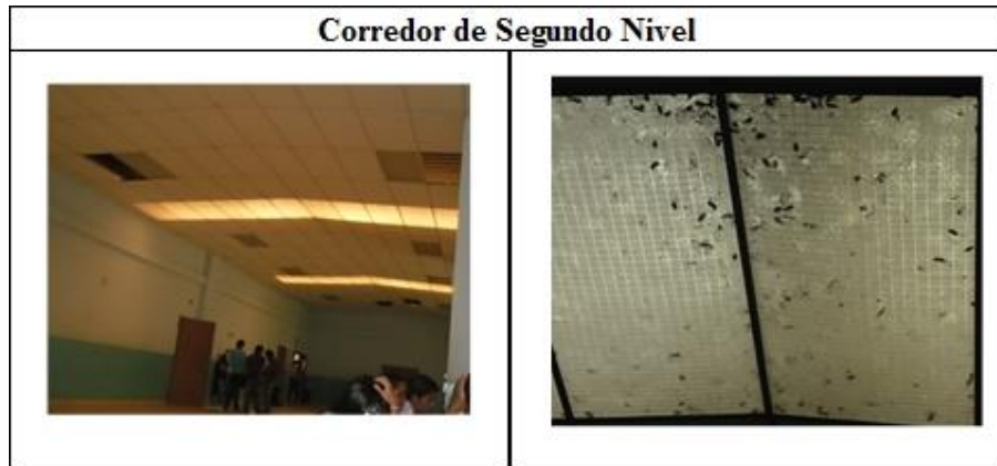
Figura 3.75. Problema iluminación natural: Tragaluces sucios en segundo nivel edificio de medicina. Fuente: Propia.
