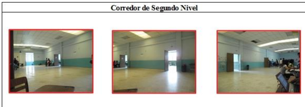
Figura 3.74. Problema iluminación natural: Corredor de Medicina segundo nivel sin ventanas. Fuente Propia
