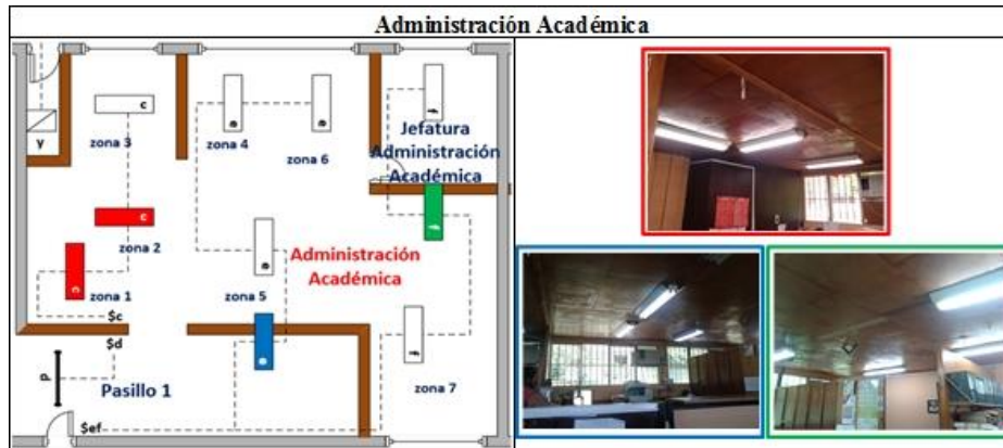
Figura 3.58. Problema de ubicación: Luminarias en Admón. Académica sobre paredes divisorias. Nota: Los problemas son en Zona 2 a color rojo, Pasillo 1 a color azul y jefatura a color verde. Fuente Propia.
