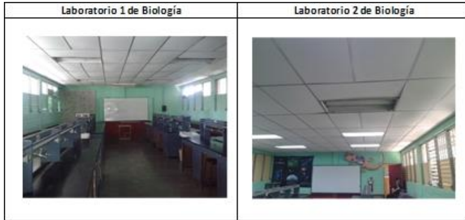
Figura 3.56. Problema iluminación natural: ventanas pintadas en laboratorios 1 y 2 de Biología. Fuente: Propia.
