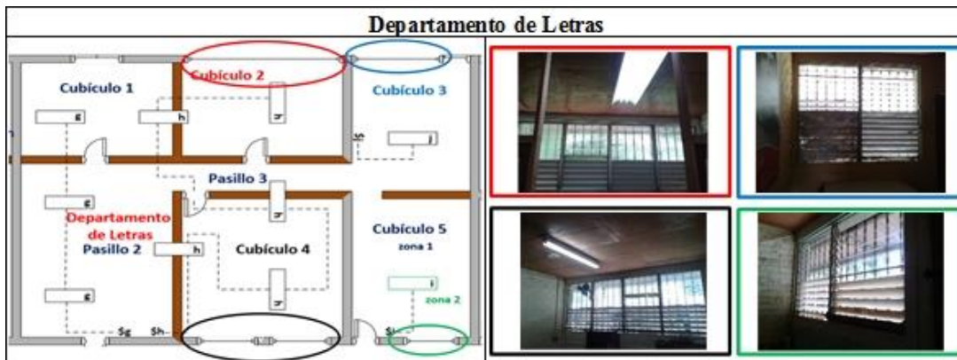
Figura 3.61. Problema iluminación natural: Ventanas pintadas en departamento de Letras. Fuente: Propia.
