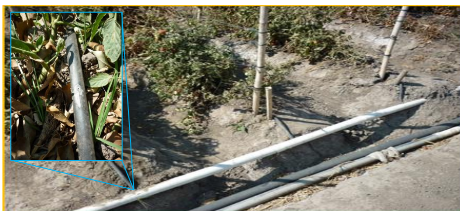
Imagen 3.3- 1: Tuberías para irrigación por goteo (PVC, 2 y 1/2 pulgadas de diámetro).
