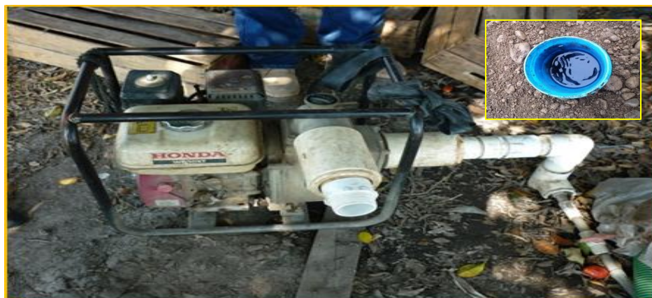
Imagen 8.3- 1: Motobomba utilizada para extraer el agua del pozo tipo puntera.
