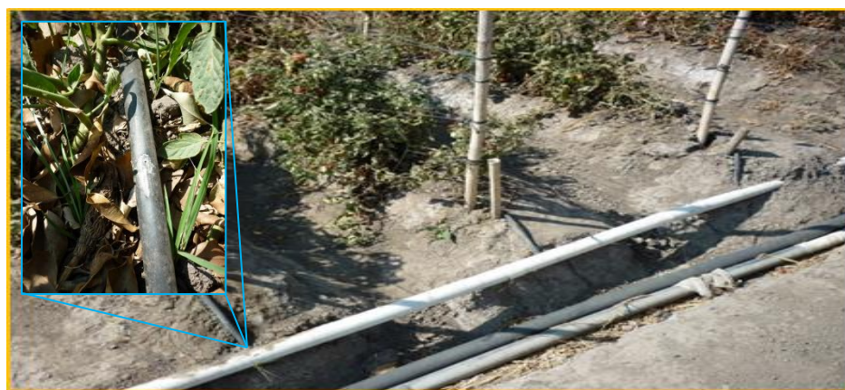
Imagen 8.3- 2: Disposición de tuberías secundarias para riego por goteo.
