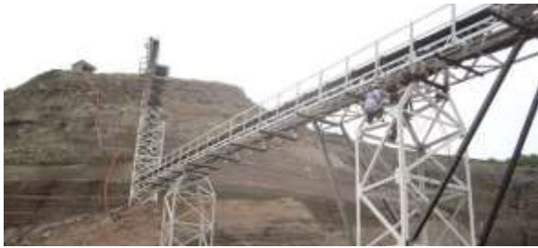
a) Banda Transportadora. Fuente: construestructuconcreto.com
