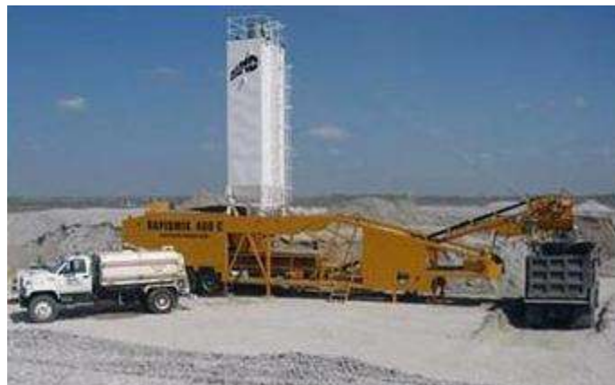
Figura 2. 7 Planta Mezcladora. Fuente: www.rollercompacted.org .
