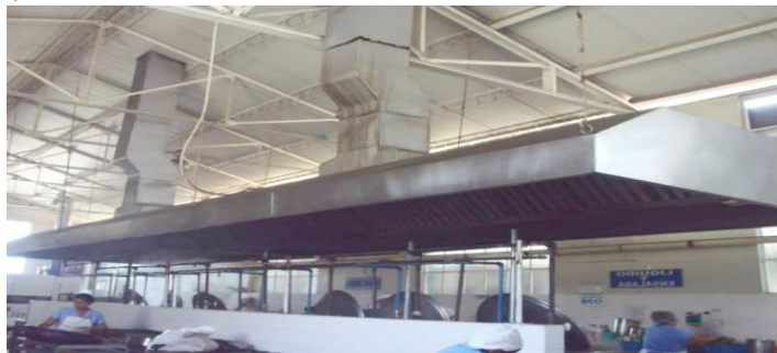
Figura n° 1 Campana extractora de vapor
