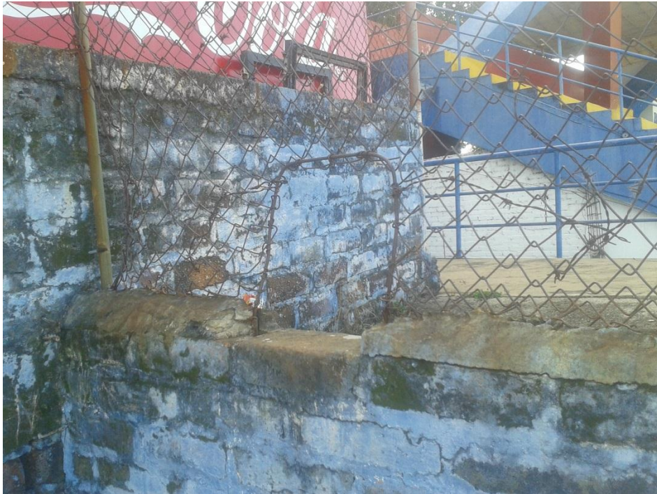
Figura 5. Infraestructura en mal estado.
