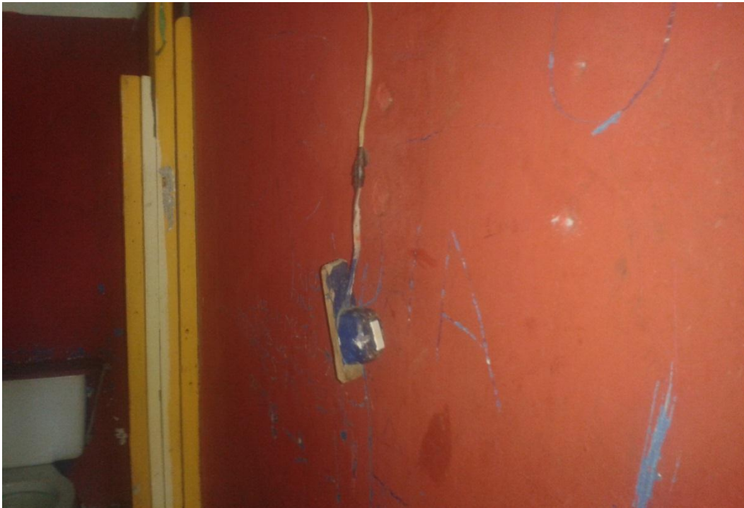
Figura 14. Interruptor de luces al descubierto y mal estado.
