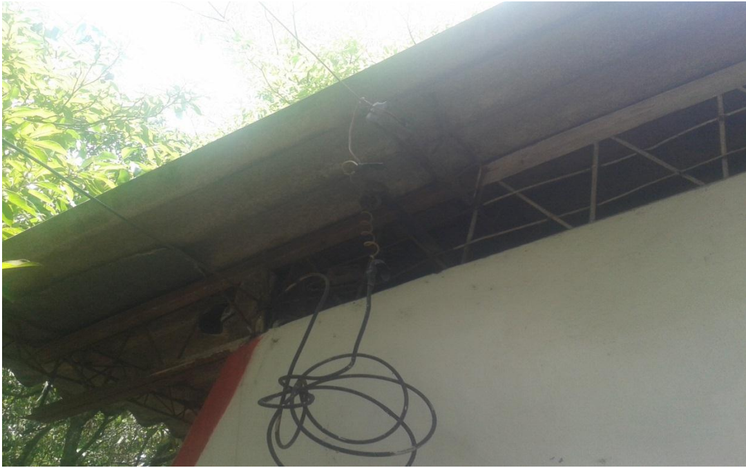
Figura 13. Instalaciones eléctricas totalmente descuidadas y con materiales en mal estados.
