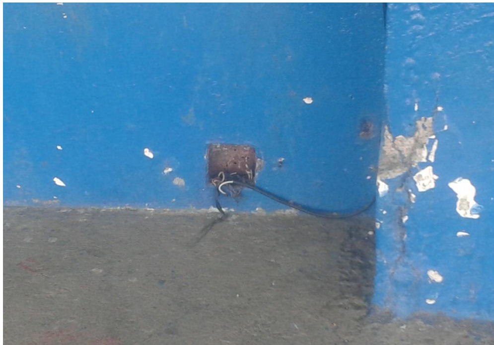
Figura 10. Cajas de registro descubiertas y sin protección.
