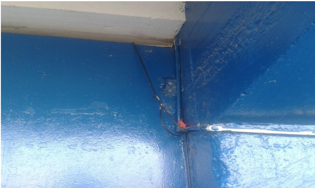
Figura 12. Cables eléctricos en área de oficina en mal estado y sin señalización de prevención.
