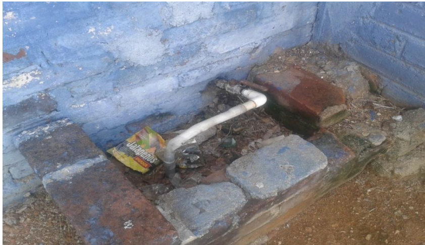
Figura 6. Tubería en mal estado.
