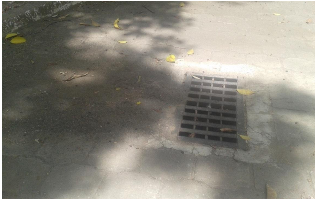
Figura 16. Rejas para las aguas lluvias en mal estados y sin ningún tipo de señalización.
