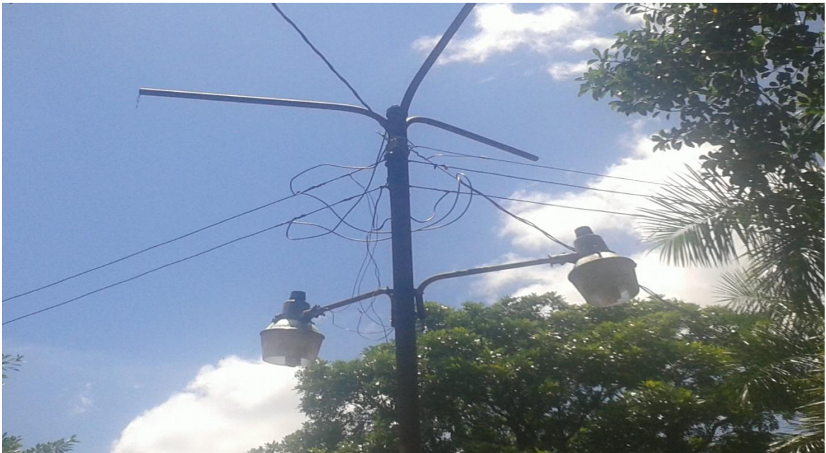
Figura 8. Cableado eléctrico en mal estado.
