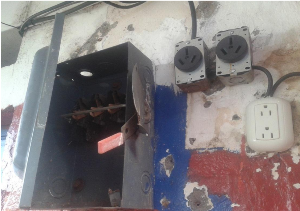
Figura 11. Caja de fusibles sin protección y sin ninguna señalización de prevención.
