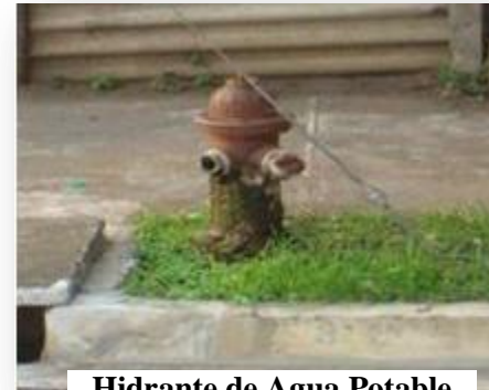
Hidrante de Agua Potable sobre 9ª. Av. Sur
