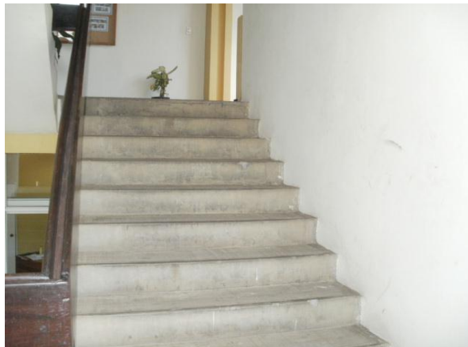
Imagen 2. Escaleras sin pasamanos.
