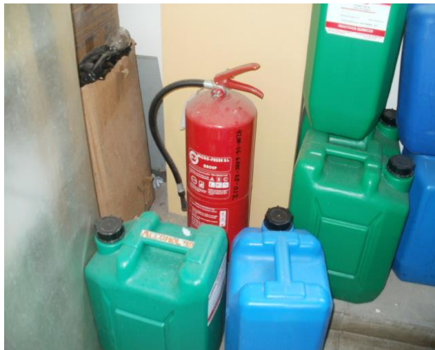
Imagen 8. Extintor mal ubicado.
