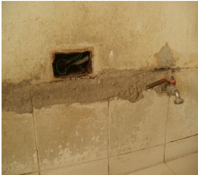
Imagen 11. Tomacorrientes en mal estado.
