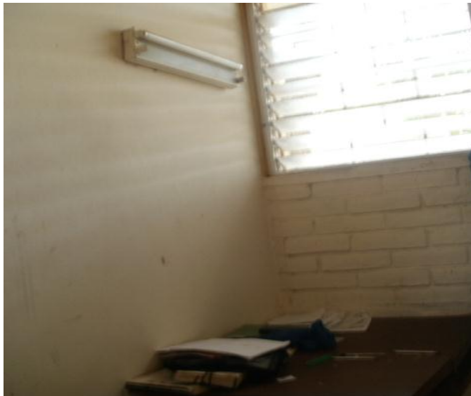
Imagen 10. Luminarias sin protección.
