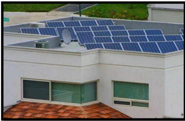
Ilustración 57 Paneles Solares Fotovoltaicos Monocristalinos.
