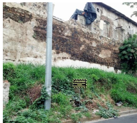
Imagen 45: Estado actual después del derrumbe
