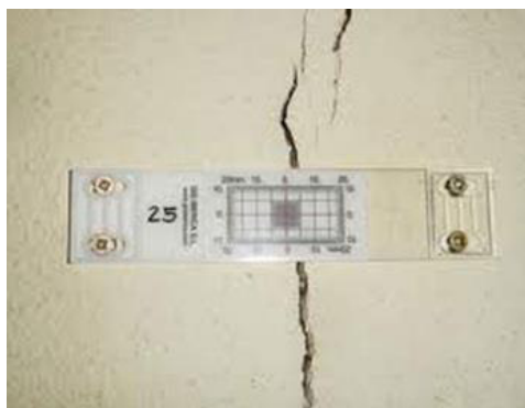
Imagen 60: Galga de Comparación de Grietas
