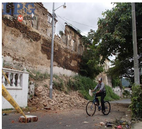
Imagen 44: Imagen luego del derrumbe
