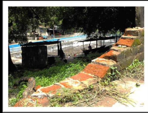
Imagen 8. Colapso del muro perimetral tras la inundación del 24/09/2014
