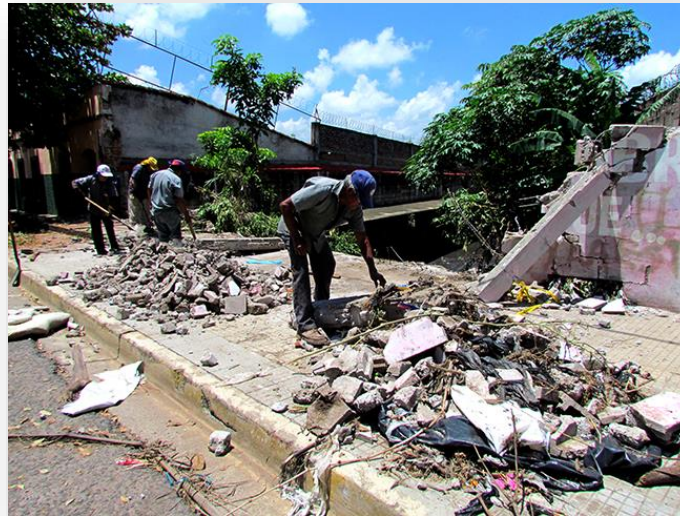
Fotografía No.20. Desbordamiento de Muro
