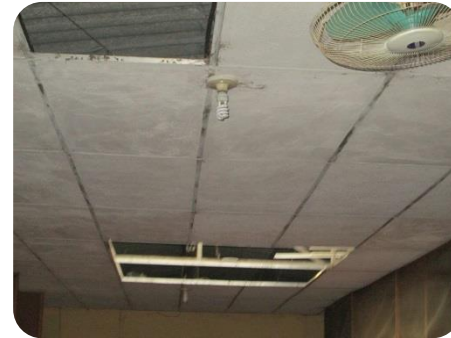
Fotografía de cielo falso y losetas faltantes
