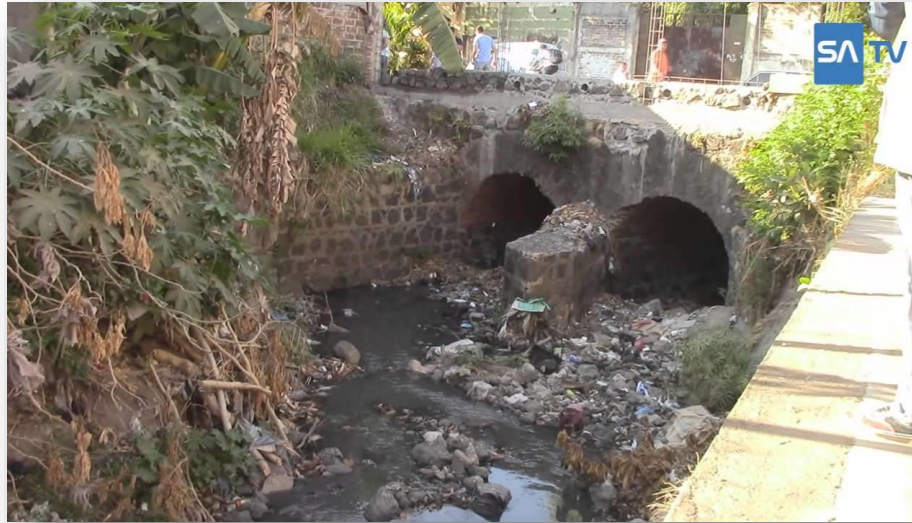
Fotografía No.21. Estancamiento de Desechos.
