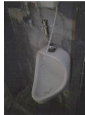
Urinario en mal estado.
