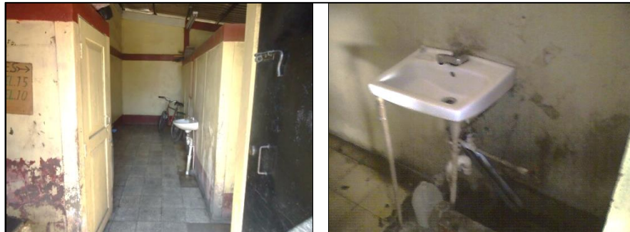
Figura 22. Servicio Sanitario Hombres. (Lavamanos)
