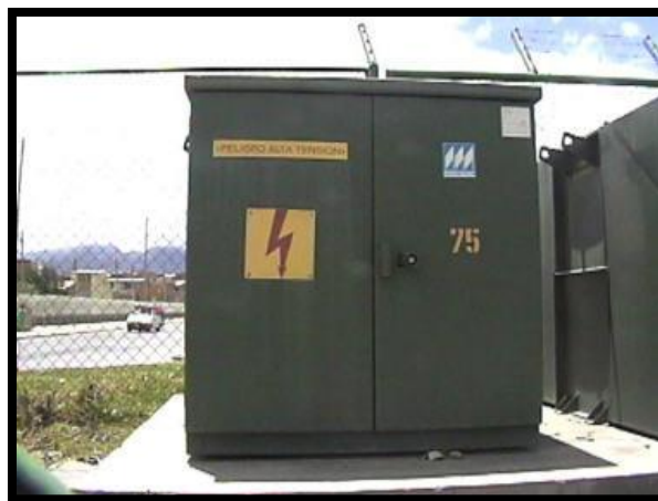
Subestación pedestal o pad mounted (tipo jardín)
