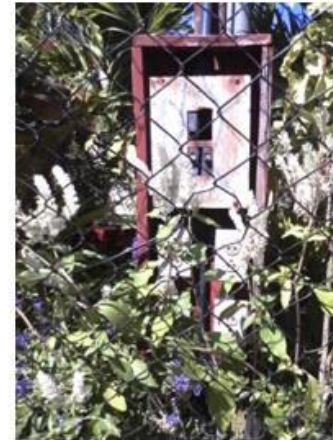
A) Caja de energía en fachada principal.
