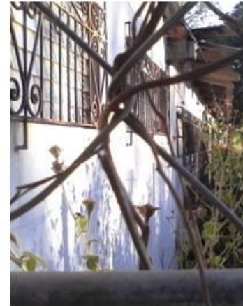
A) Ventana inutilizada en la parte posterior del edificio.
