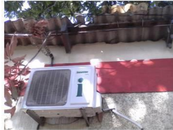
A) Equipo de aire acondicionado, oficina de secretaria.
