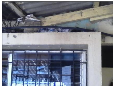
Figura 18. Estado actual de Viga de madera de Dpto. Registró Familiar
