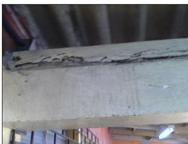
Figura 17. Estado actual de Viga de Madera, Corredor de Dpto. de Tesorería
