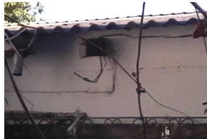
B) Cables expuestos a la intemperie.
