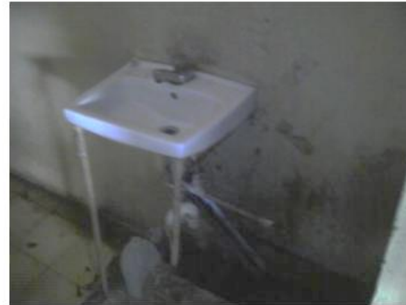
Lavamanos servicio sanitario de hombres.
