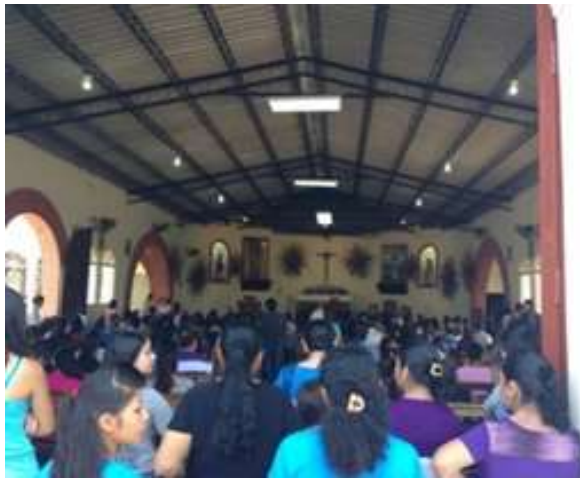
Imagen 3: falta de cielo falso
