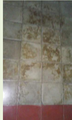
IMAGEN 055 MANCHAS DE HUMEDAD EN PISO
