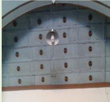
IMAGEN 013 DAÑO POR FILTRACION DE AGUA
