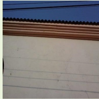
IMAGEN 014 DAÑO POR FISURAS
