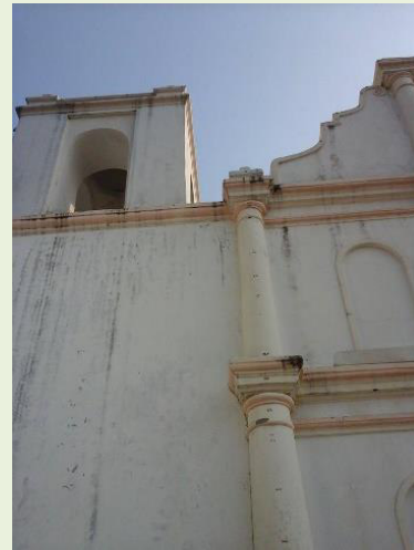
IMAGEN 002 DAÑO DE HUMEDAD POR CONDENSACION
