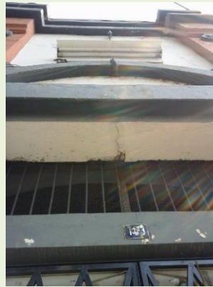
IMAGEN 046 DAÑO POR FISURA
