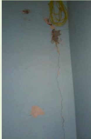
IMAGEN 054 DAÑO EN PARED, FISURA
