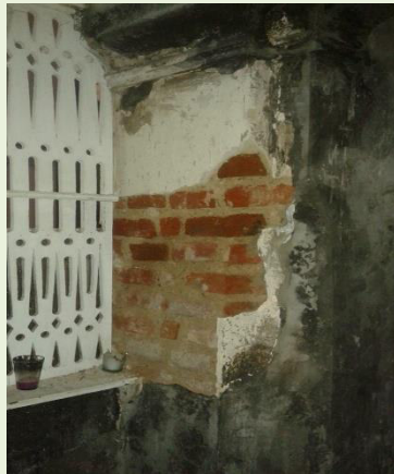
IMAGEN 001 DESPRENDIMIENTO DE MATERIAL POR GOLPES
