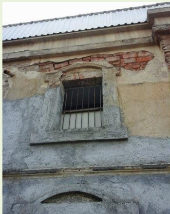
IMAGEN 033 DESPRENDIMIENTO DE MATERIAL
