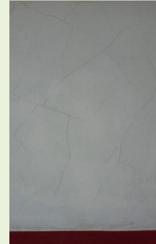
IMAGEN 056 DAÑO EN PARED, FISURA
