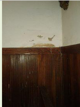
IMAGEN 014 DAÑO DE HUMEDAD POR CAPILARIDAD
