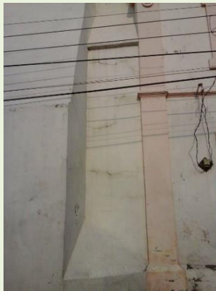
IMAGEN 017 MANCHAS POR HUMEDAD
