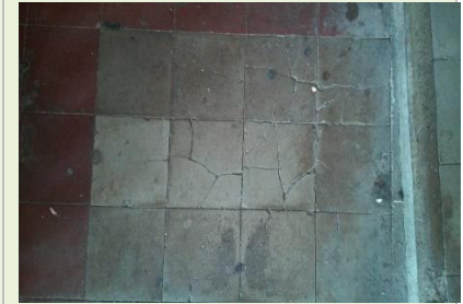
IMAGEN 040 DAÑO EN PISO POR ENVEJECIMIENTO
