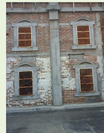
IMAGEN 036 TRATAMIENTO INCONCLUSO EN PARED
