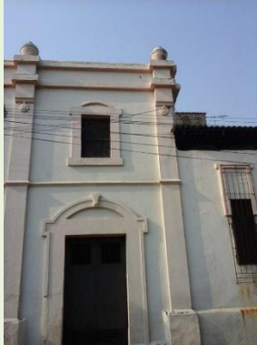
IMAGEN 021 MANCHAS POR HJUMEDAD
