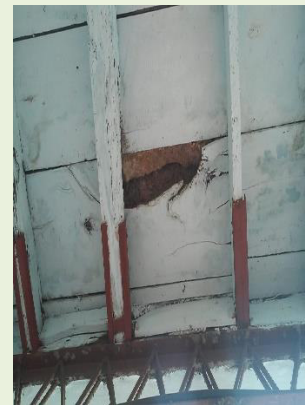
IMAGEN 035 DAÑO EN ENTREPISO
