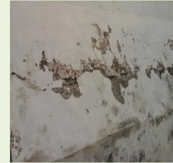
IMAGEN 016 DESCASCAMIENTO DE PINTURA Y MANCHAS DE HUMEDAD
