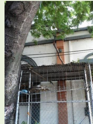
IMAGEN 043 DAÑO POR FISURAS
