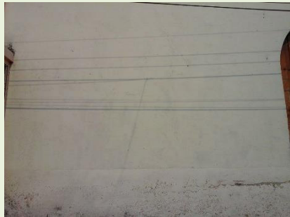
IMAGEN 013 MANCHAS DE HUMEDAD
