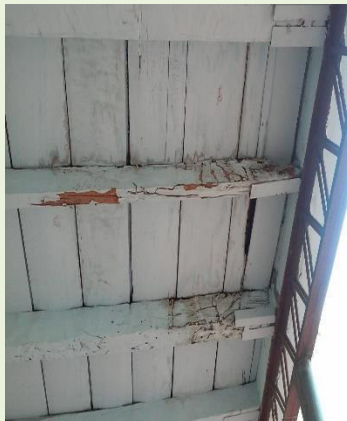
IMAGEN 033 VIGAS DAÑADAS DEL ENTREPISO
