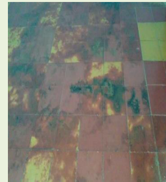
IMAGEN 051 MANCHAS DE HUMEDAD EN PISO
