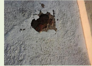
IMAGEN 024 DESPRENDIMIENTO DE MATERIAL POR GOLPES
