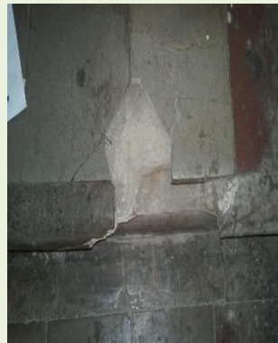
IMAGEN 042 DAÑO EN PISO POR GOLPES
