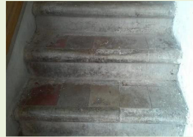
IMAGEN 039 DAÑO EN PISO POR ENVEJECIMIENTO ESCALERAS
