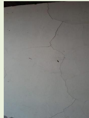
IMAGEN 043 DAÑO EN PARED, FISURA
