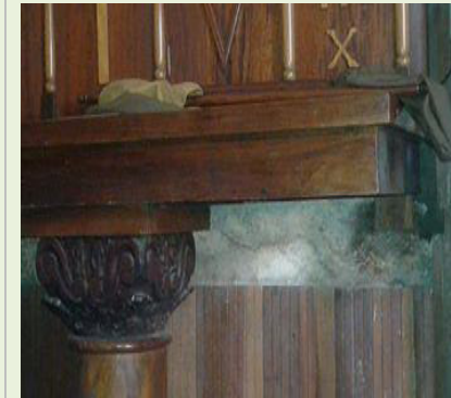
IMAGEN 008 MANCHAS DE HUMEDAD POR CAPILARIDAD
