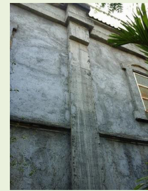
IMAGEN 028 PROCEDIMIENTO INADECUADO EN EL REPELLO
