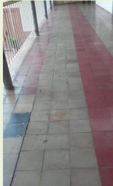
IMAGEN 045 DESNIVELES O SOPLADOS EN PISOS
