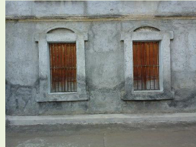
IMAGEN 038 MANCHAS POR HUMEDAD Y DAÑOS POR FISURAS
