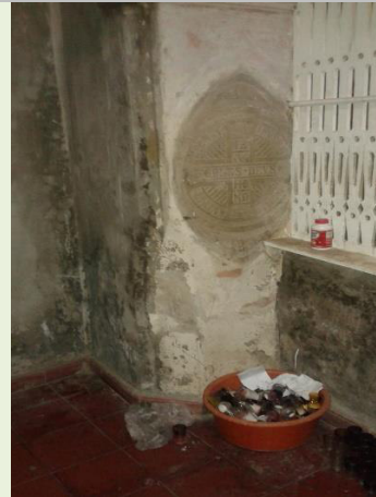
IMAGEN 002 MANCHAS DE HUMEDAD POR CAPILARIDAD
