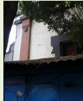
IMAGEN 039 DAÑO POR FISURAS
