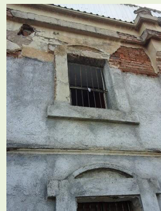
IMAGEN 035 DESPRENDIMIENTO DE MATERIAL
