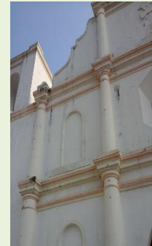
IMAGEN 004 DESCASCARONAMIENTO DE MATERIAL EN REMATE DE COLUMNA
