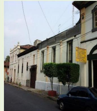
IMAGEN 027 FALTA DE VIGA DE CORONAMIENTO
