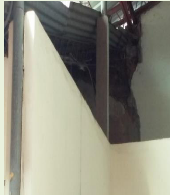
IMAGEN 038 DESPRENDIMIENTO DE MATERIAL POR GOLPES O ELEMENTOS PUNZANTES
