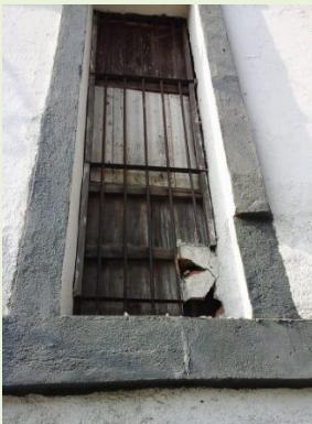
IMAGEN 025 DESPRENDIMIENTO EN VENTANA
