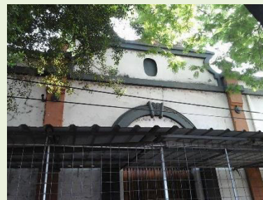
IMAGEN 042 DAÑO POR FISURAS
