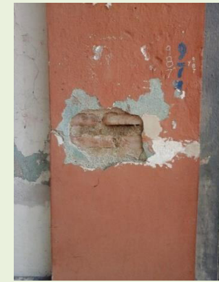
IMAGEN 044 DESPREDIMIENTO DE MATERIAL POR TEMPERATURA
