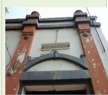
IMAGEN 048 DESCASCARAMIENTO DE PINTURA
