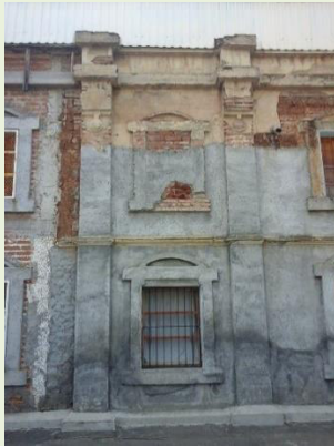
IMAGEN 037 DESPRENDIMIENTO DE MATERIAL
