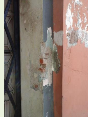
IMAGEN 047 DESPRENDIMIENTO DE MATERIAL Y DESCASCARAMIENTO DE PINTURA
