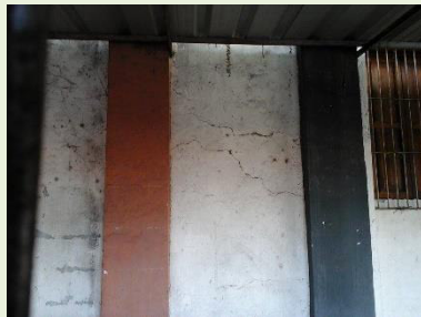
IMAGEN 041 DAÑOS POR FISURAS
