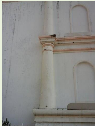
IMAGEN 001 FACHADA SUR, DAÑO DE HUMEDAD POR CONDENSACION
