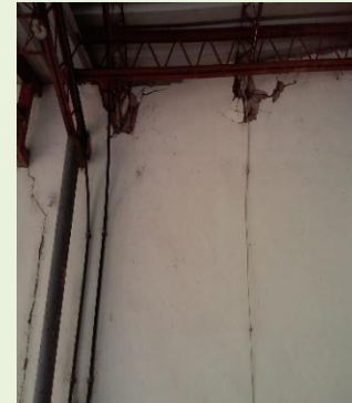
IMAGEN 047 DAÑO EN PARED POR FISURAS Y GOLPES
