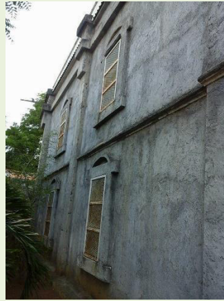
IMAGEN 030 MAL PROCEDIMIENTOS AL REPELLAR
