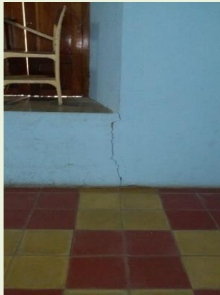
IMAGEN 049 DAÑO EN PARED POR FISURA
