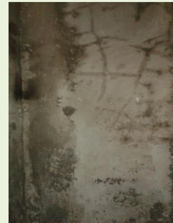
IMAGEN 003 MANCHAS DE HUMEDAD POR CAPILARIDAD
