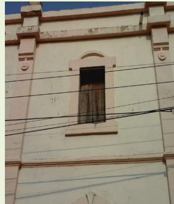
IMAGEN 018 MANCHAS POR HUMEDAD
