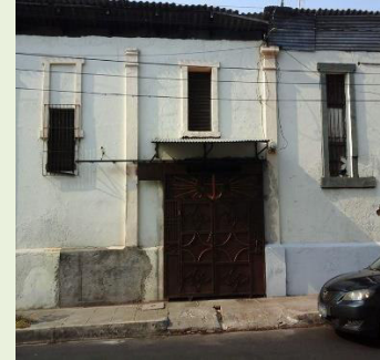
IMAGEN 023 RESANE POR DESPRENDIMIENTO DE MATERIAL
