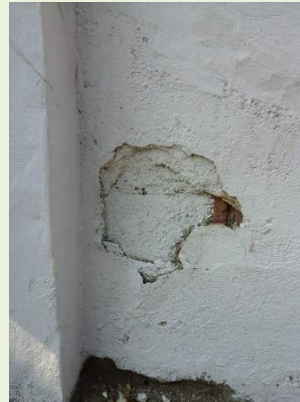
IMAGEN 025 DESPRENDIMIENTO DE MATERIAL POR GOLPES
