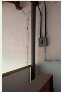
IMAGEN 046 DAÑO EN PARED, FISURAS
