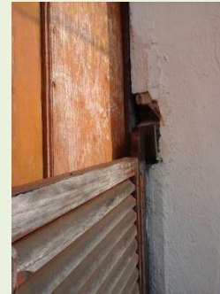
IMAGEN 015 DESPERDICIAMIENTO DE MATERIAL POR GOLPES O ELEMENTOS PUNZANTES
