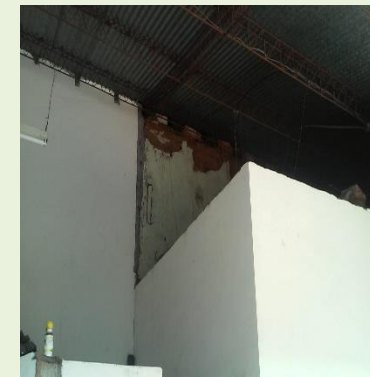
IMAGEN 036 DESPRENDIMIENTO DE REPELLO
