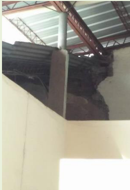
IMAGEN 037 DESPRENDIMIENTO DE MATERIAL POR GOLPES O ELEMENTOS PUNZANTES
