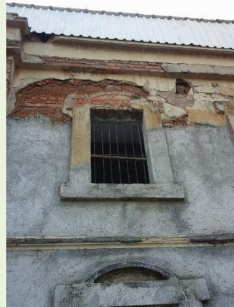
IMAGEN 034 DESPRENDIMIENTO DE MATERIAL
