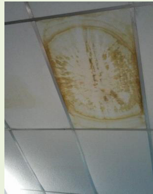
IMAGEN 050 MANCHA DE HUMEDAD POR FILTRACION
