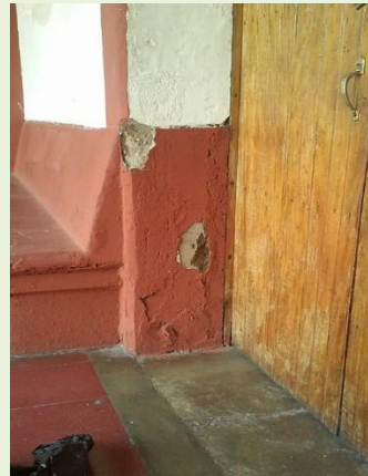
IMAGEN 034 DESPRENDIMIENTO DE MATERIAL
