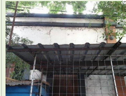
IMAGEN 040 DAÑO POR FISURAS
