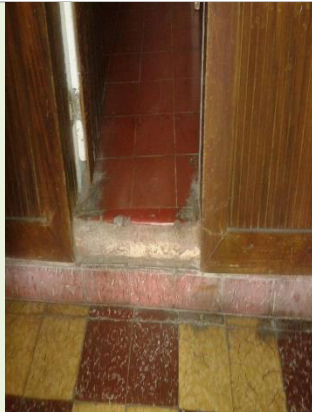
IMAGEN 005 DAÑO EN PISOS POR GOLPES
