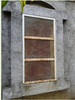
IMAGEN 029 MAL PROCEDIMIENTOS AL REPELLAR
