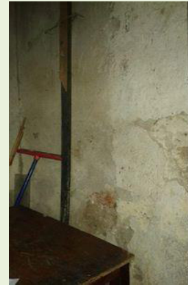
IMAGEN 015 DAÑO POR HUMEDAD EN PARED
