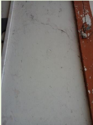
IMAGEN 045 DESCASCARAMIENTO DE PINTURA
