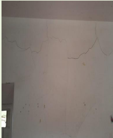
IMAGEN 053 DAÑO EN PARED, FISURA
