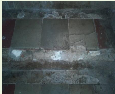
IMAGEN 041 DAÑO EN PISO POR GOLPES
