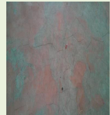
IMAGEN 052 MANCHAS DE HUMEDAD EN PISO
