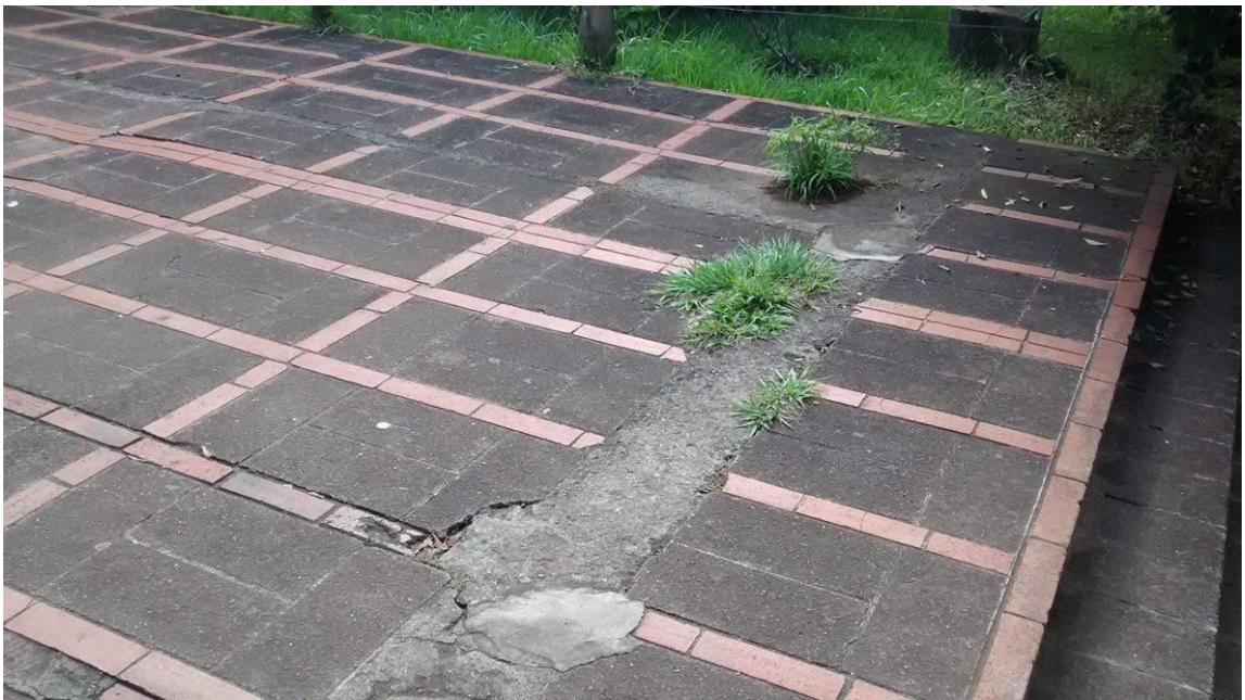
Ilustración 27 Desnivel en el recorrido de la plaza. Desnivel que presenta crecimiento de vegetación.
