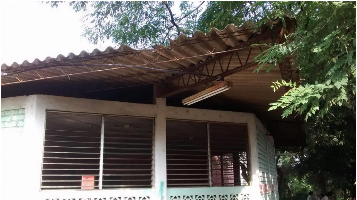
Ilustración 36 Estado del techo del Aula 10
