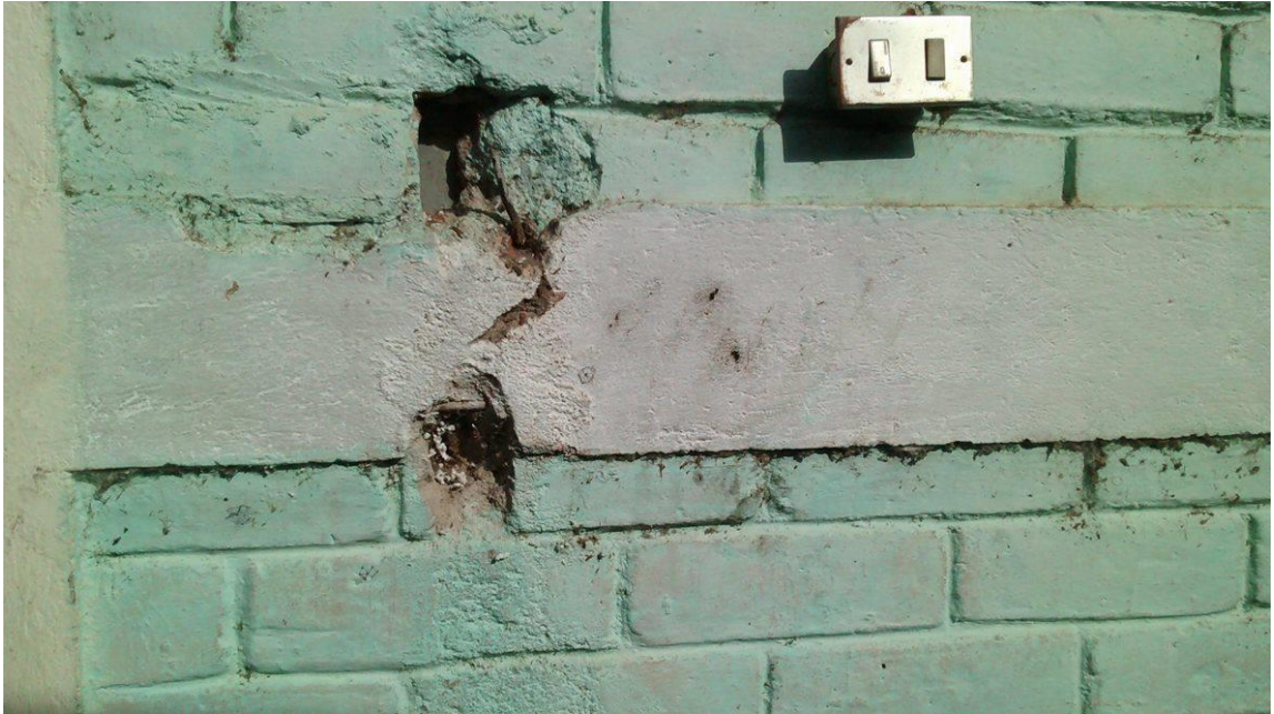
Ilustración 35 Daños en la pared exterior del Aula 10
