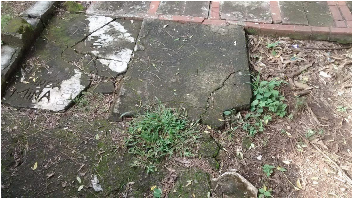
Ilustración 32 Situación actual de la losa de la plaza de estudio "Ingeniería 2001"
