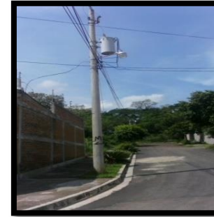
Postes de Electricidad
