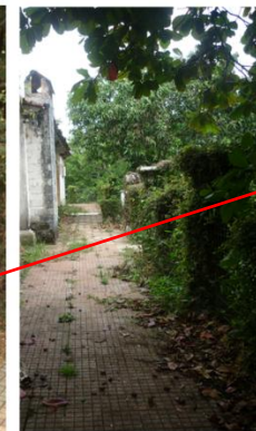
DETALLE DE ESTADO ACTUAL DE VERJA EN AREA DE PISCINA
