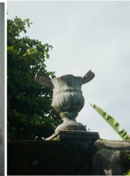
DETALLE DE ESTADO ACTUAL DE COPON EN (F1)
