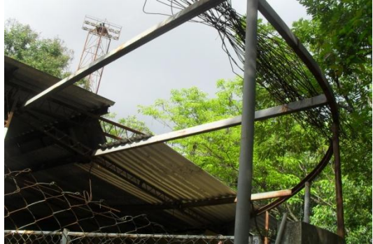
Fotografía 3.4.7: Piezas faltantes en el techo
