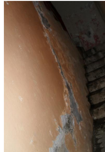
Fotografía 3.4.20: Daños por humedad en muros y piso de túnel equipo local
