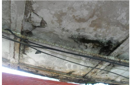
Fotografía 3.4.15: Daños en losa de techo por humedad en canal de desagüe
