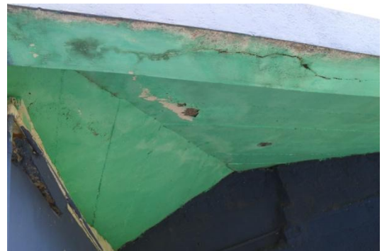
Fotografía 3.4.18: Daños en vigas de cubierta de puesto de venta V1
