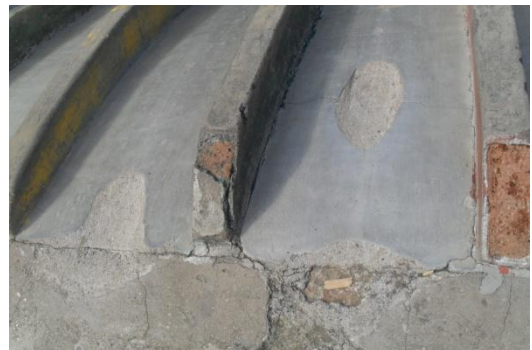
Fotografía 3.4.5: Daños en tobogán
