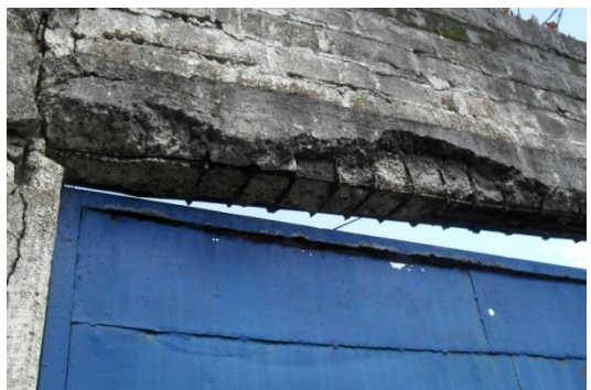
Fotografía 3.4.11: Daños en dintel de acceso A9
