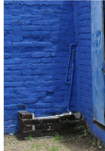
Fotografía 3.4.23: Tuberías expuestas en servicios sanitarios al suroeste del estadio
