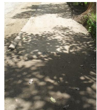
Fotografía 3.2.4: Final de la acera al sur del terreno
