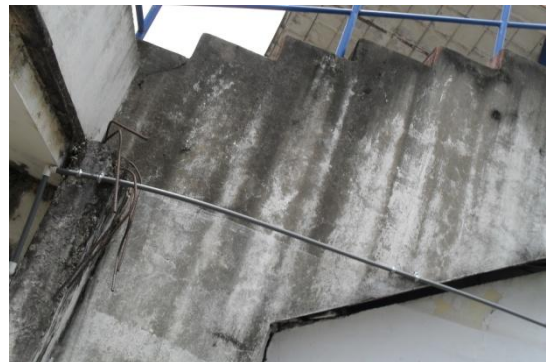
Fotografía 3.4.24: Tuberías expuestas en Tribuna, al noroeste del estadio
