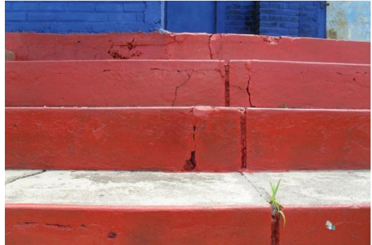
Fotografía 3.4.12: Agrietamientos en graderíos cerca de junta de dilatación
