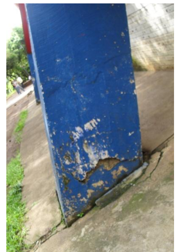
Fotografía 3.4.14: Daños en base de Columna G
