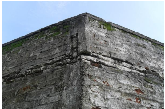
Fotografía 3.4.10: Daños en muro, unión de tramos P13-C y P14-A
