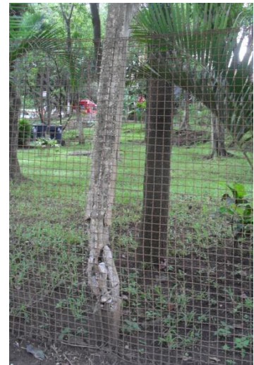
Fotografía 3.4.2: Pilote de concreto colapsado
