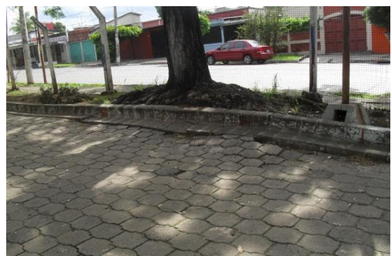
Fotografía 3.4.4: Desniveles en adoquinado y cordón provocados por crecimiento de raíces
