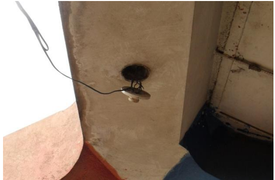
Fotografía 3.4.25: Instalaciones eléctricas en la estructura de la cubierta en Tribuna
