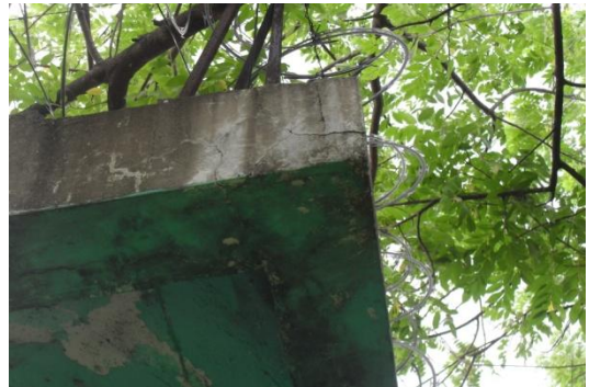
Fotografía 3.4.16: Daños en vigas de cubierta de taquilla T1
