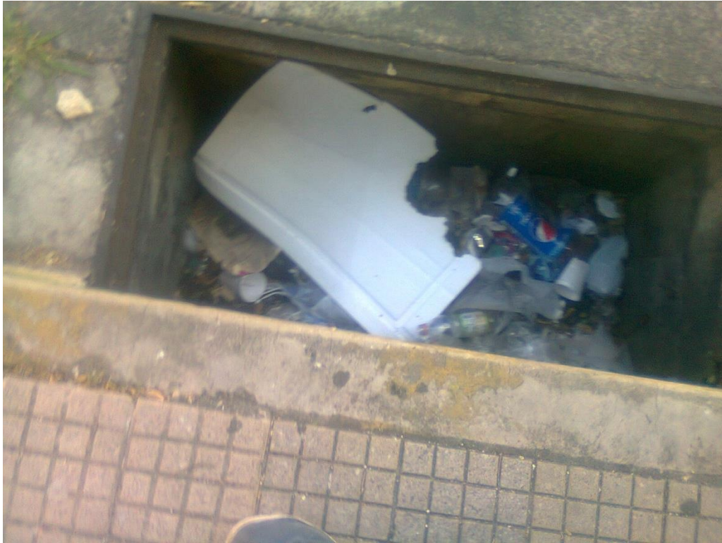
Saturación de desechos sólidos en los tragantes.
