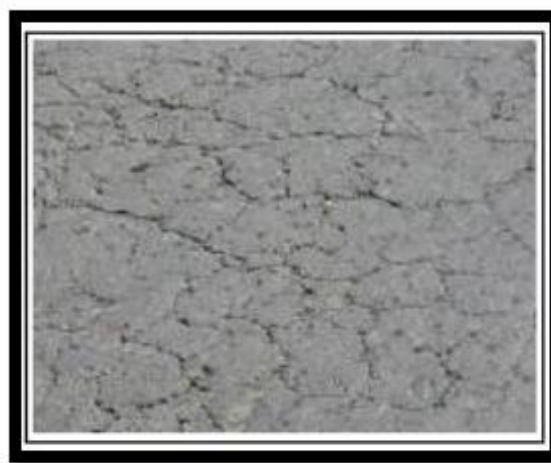
Figura 5. “Piel de Cocodrilo”. (Fuente: Manual de Carreteras, Volumen 7, 2012)
