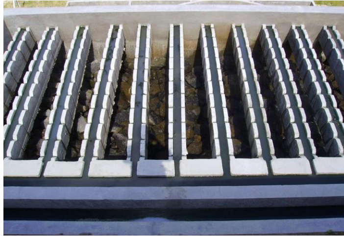
Figura 2.8 - Vista superior de un filtro percolador, en las que se observan las canaletas distribuidoras de caudal. FUENTE: Tratamiento de aguas residuales domésticas en Centroamérica.
