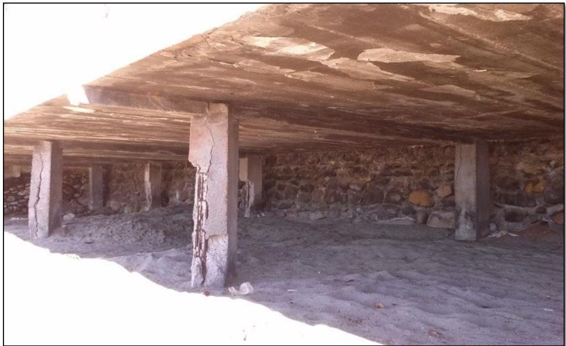
Imagen 1.1: Daño ocasionado en estructura, playa el Cuco Fuente: Grupo de tesis
