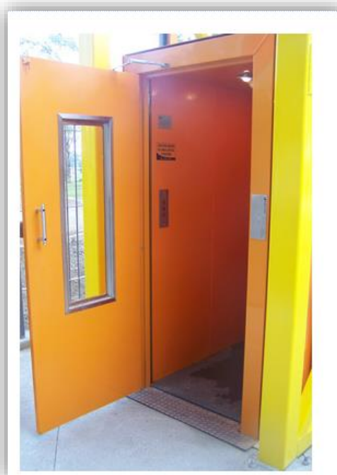
Figura 100: Ilustración de entrada a elevador.
