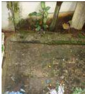
24: Piso deteriorado y sucio.
