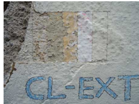
...3. Realizada en pared exterior ... la Gobernación de Sonsonate
