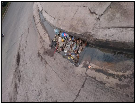
Figura 19: Estado de tragantes del sistema de drenaje de la carretera.
