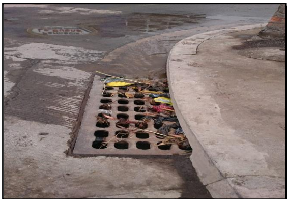
Figura 20: Tragante obstaculizado por residuos sólidos.
