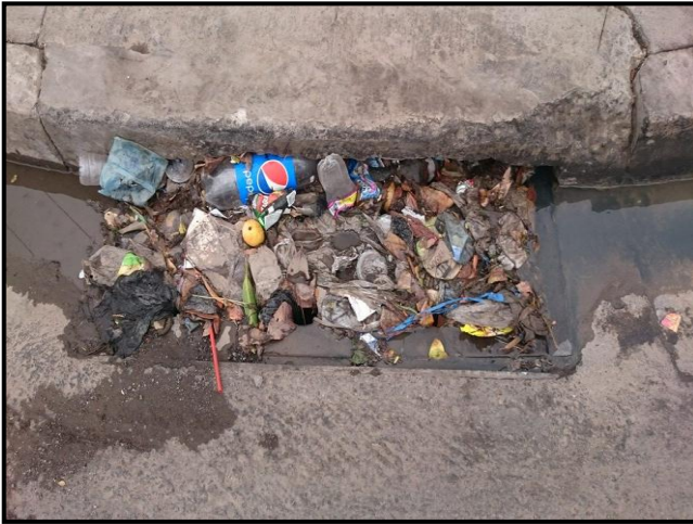
Figura 12: Obstrucción de tragantes por desechos sólidos.
