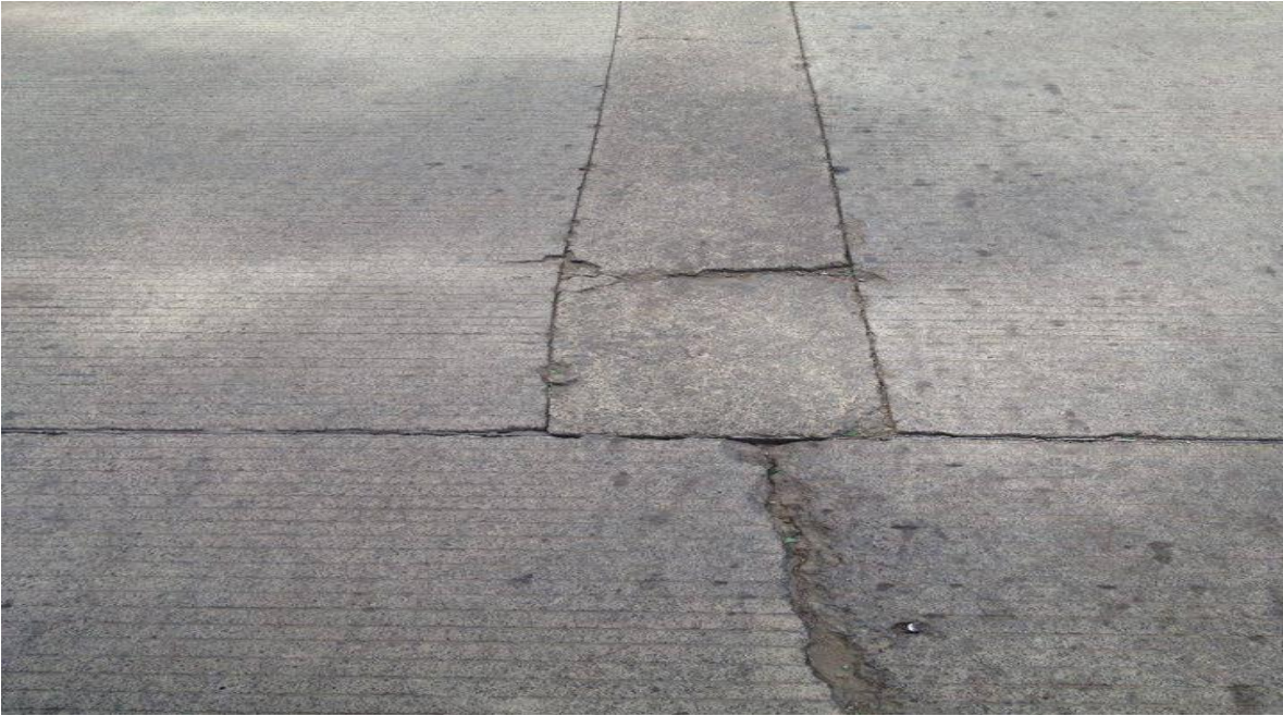
Daño 29: parche grande (reparación por acometida)
