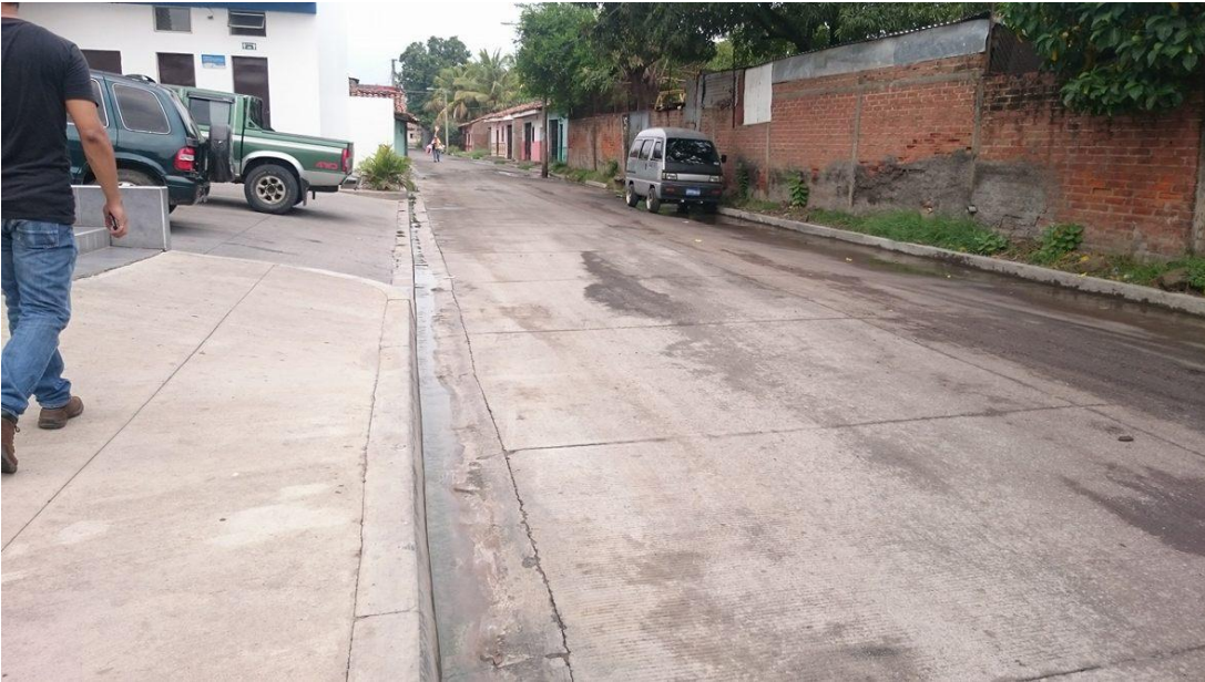
Calle Carranza, descarga de escorrentía superficial sobre Calle Antigua a La Unión (Zona de inundación).
