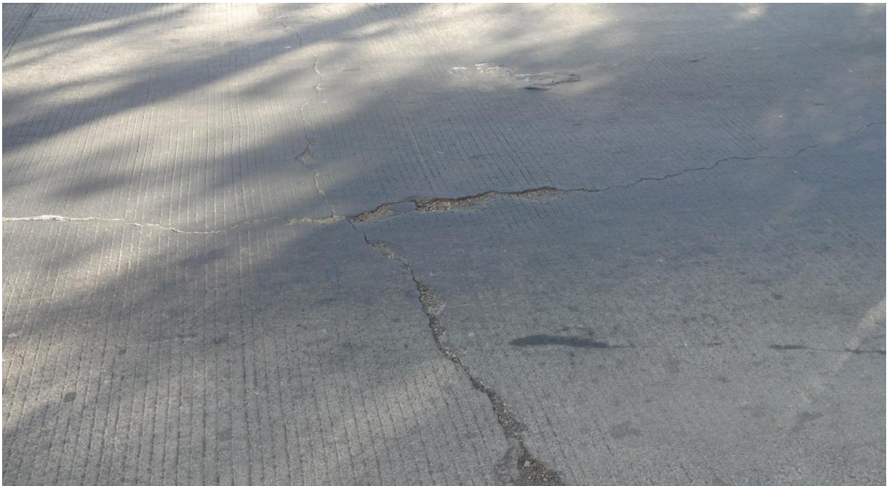
Daño 23: Losa dividida (Rotura en cuatro o más pedazos).
