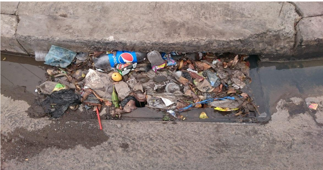
Estado de tragantes del sistema de drenaje de la vía.
