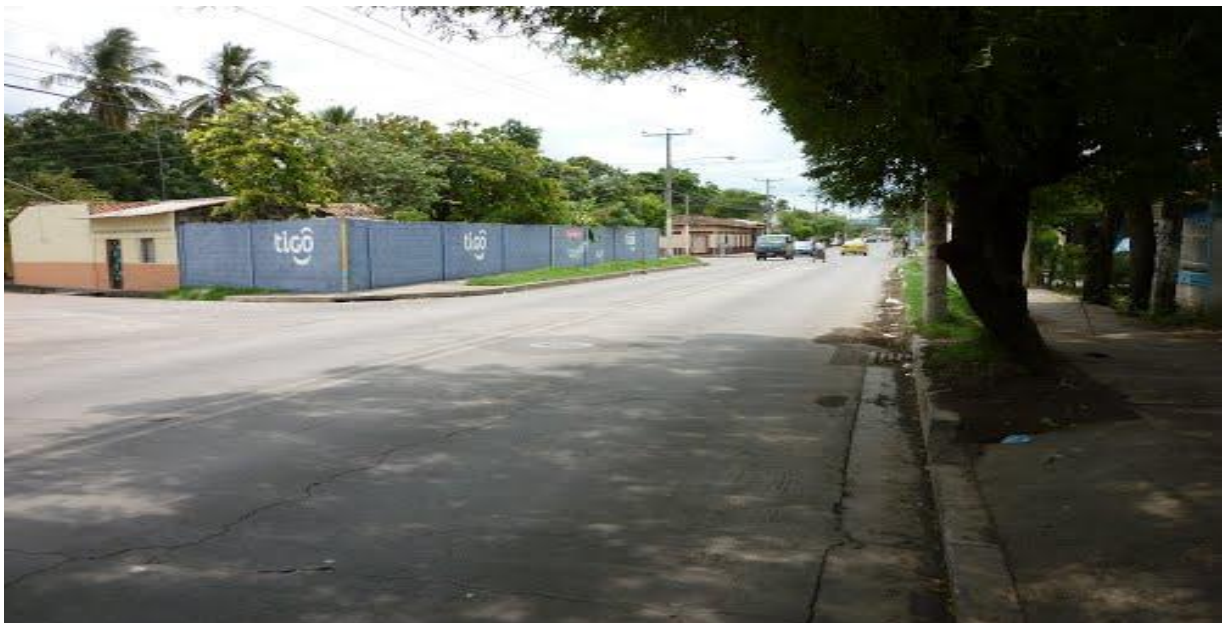
Daño 28: Grietas lineales (Longitudinal, transversal y diagonal) (Dividen la losa en dos o tres pedazos).
