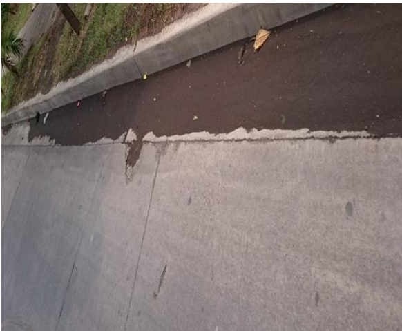
Figura 3: Estado del drenaje superficial de la carretera.
