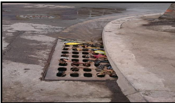
Figura 13: Estado actual de tragantes.
