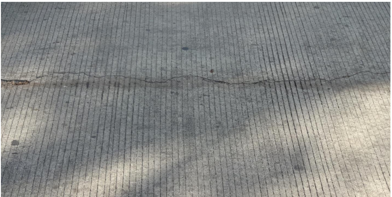
Daño 28: Grietas lineales (Longitudinal, transversal y diagonal) (Dividen la losa en dos o tres pedazos).
