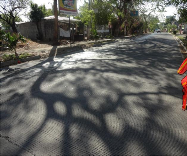
Figura 5: Condición superficial del pavimento.
