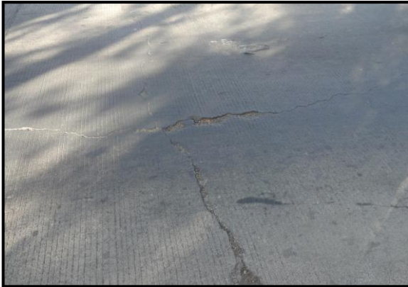
Figura 18: Daños sobre la superficie del pavimento.
