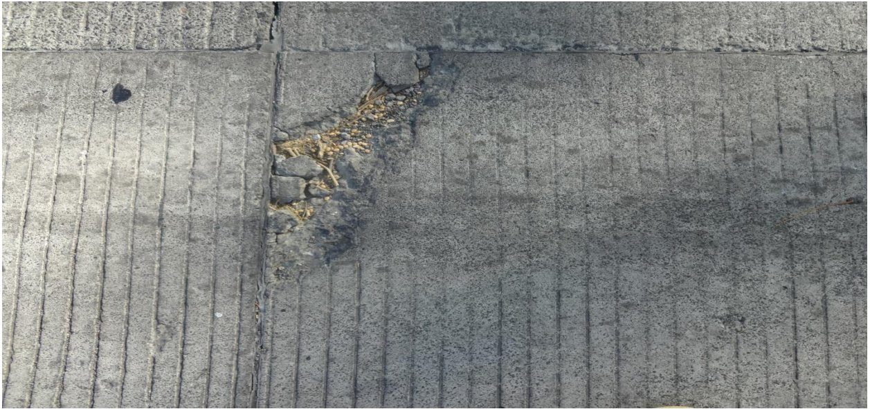
Daño 22: Rotura de la esquina (grieta que intercepta dos bordes).
