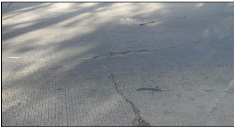
Figura 1: Deterioros presentes en el estado actual de la avenida Coronel Miguel Ángel Benett.
