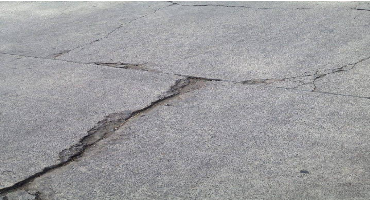
Daño 22, 28: Grieta de borde y longitudinal, daño en la junta
