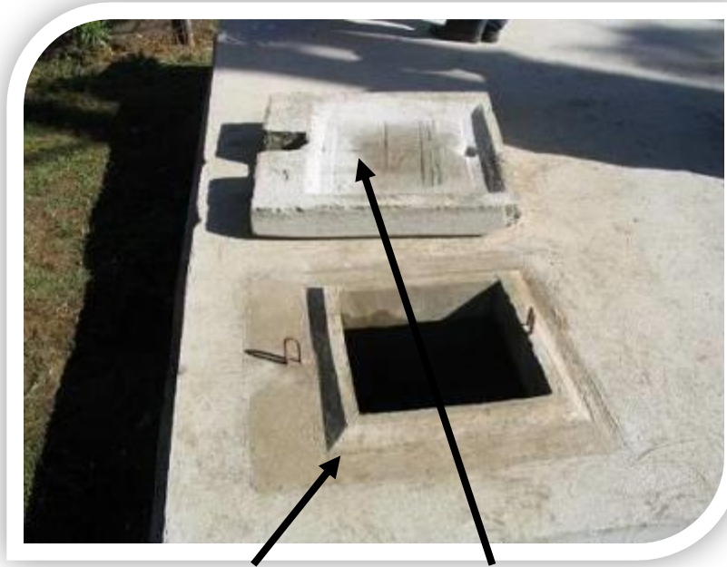
Figura 5.17. Sello sanitario abajo la tapadera bien formado
