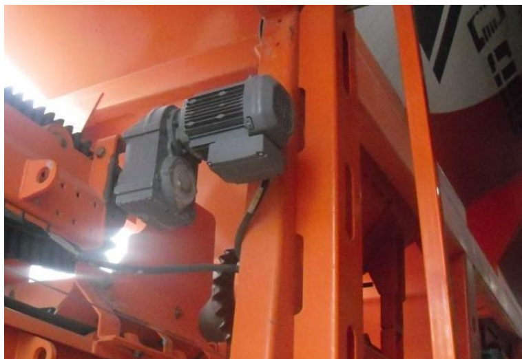
Figura 3.6. Celda de carga de alta precisión. Garantiza el control en la dosificación de los agregados. Fuente: Registro propio.
