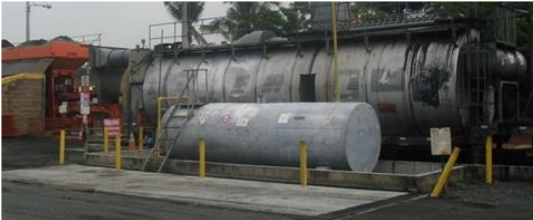
Figura 3.12. Tanque térmico para almacenamiento del asfalto. Fuente: Registro propio.
