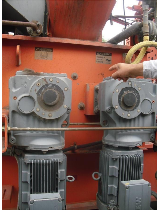
Figura 3.11. Motorreductoras del mezclador. El mezclador está completamente separado del secador. Fuente: Registro propio.
