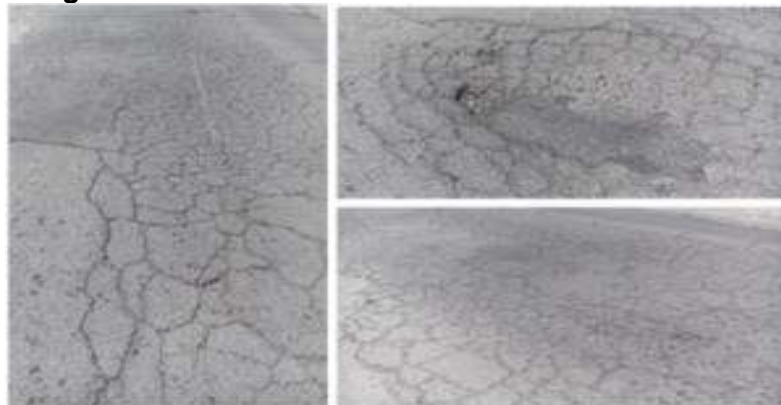
Imagen 3.15. Piel de cocodrilo en intersección DV-CAG.
