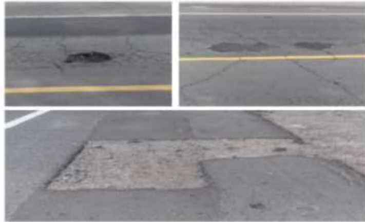
Imagen 3.14. Recarpeteo y desprendimiento en intersección de DV-RN.
