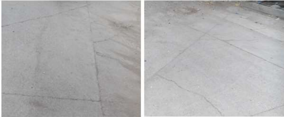
Imagen 3.18. Grietas de contracción en pavimento hidráulico en calle rural MOR24E.
