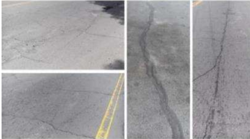
Imagen 3.8. Fisuras horizontales y verticales en intersección de CAM-DV.
