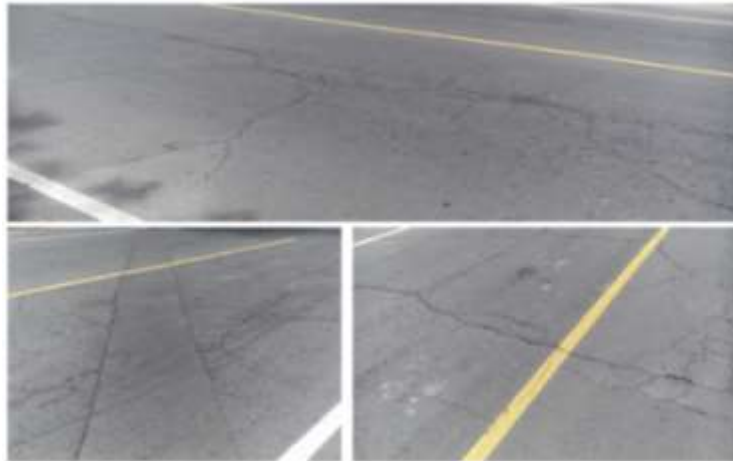
Imagen 3.12. Fisuras horizontales y verticales en intersección DV-RN.
