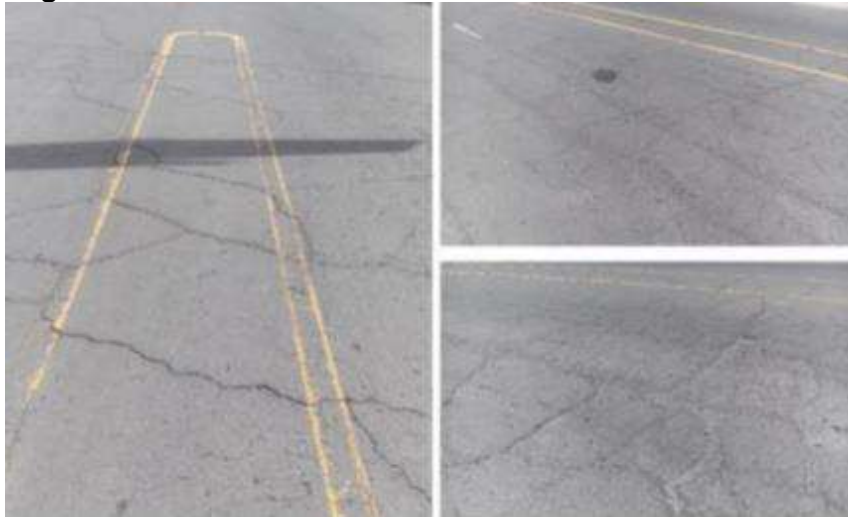
Imagen 3.9. Grietas de contracción en intersección de CAM-DV.
