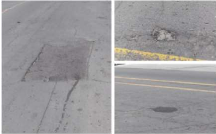
Imagen 3.10. Recarpeteo y desprendimiento en intersección de CAM-DV.
