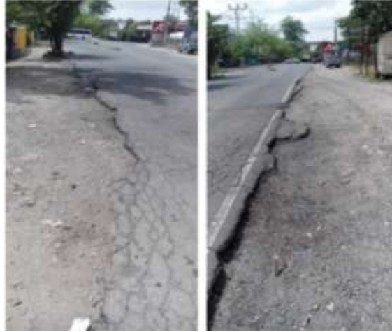
Imagen 3.16. Estado del pavimento donde no hay hombros.
