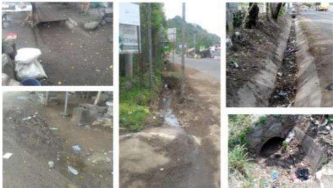
Imagen 3.6 Basura y materiales orgánicos obstruyendo canaletas.
