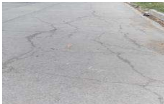
Imagen 3.17. Fisuras horizontales en pavimento hidráulico de calle rural MOR24E.
