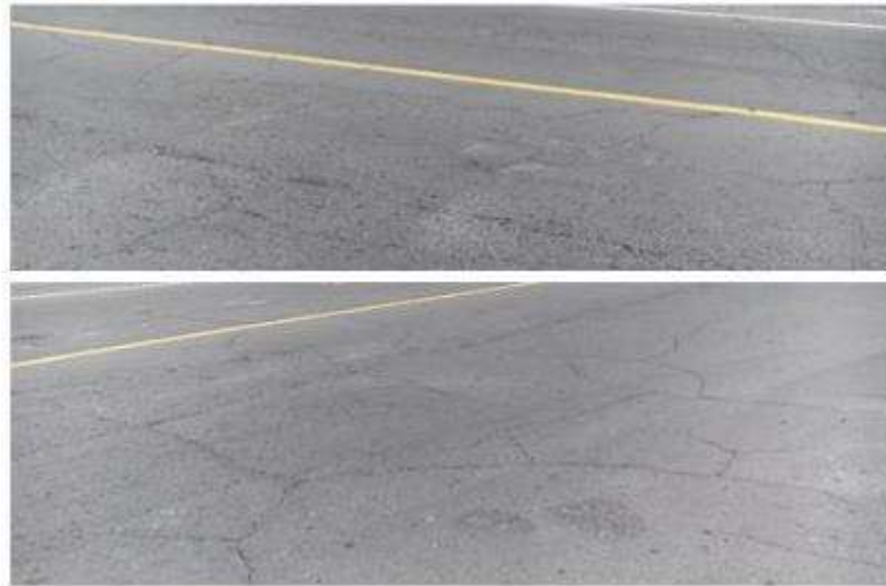
Imagen 3.13. Grietas de contracción en intersección DV-RN.
