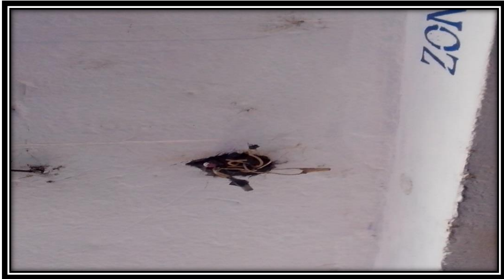
Figura 8. Techo con cables eléctricos a la intemperie
