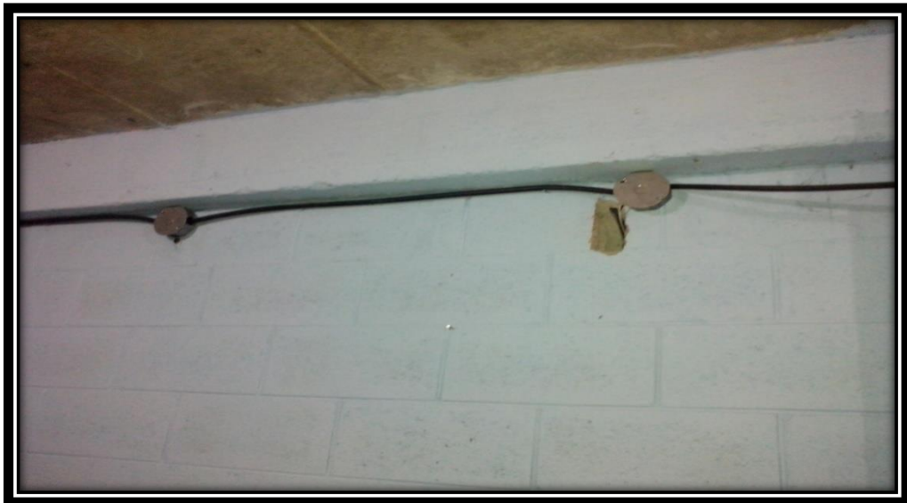
Figura 29. Cables del centro de cómputo
