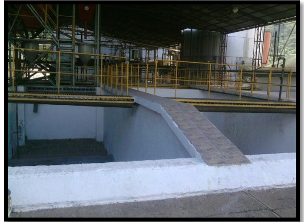
Imagen 26. Pilas de recepción
