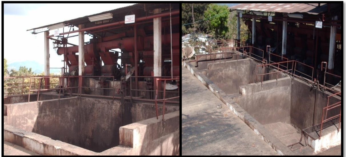
Imagen 39. Pilas de Recepción
