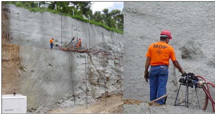
Ilustración 16- Este talud ha sido revestido con concreto lanzado para evitar que la superficie del mismo quede a la intemperie y afecte los trabajos futuros.
