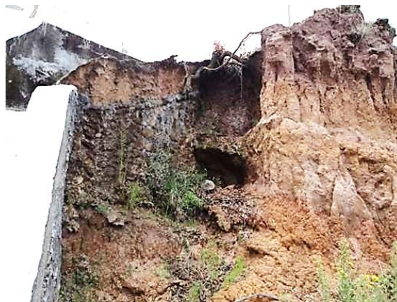
Ilustración 20- Consecuencia de mal drenaje, talud erosionado
