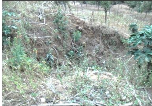
Figura 6 -Deslizamiento traslacional en tramo de la Carretera Cacaopera-Corinto.
