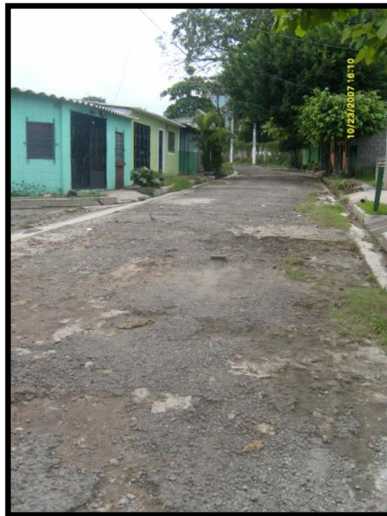
VISTA PANORÁMICA DEL ESTADO GENERAL DE LAS CALLES Y AVENIDAS EN LA URBANIZACIÓN "EL MILAGRO"
