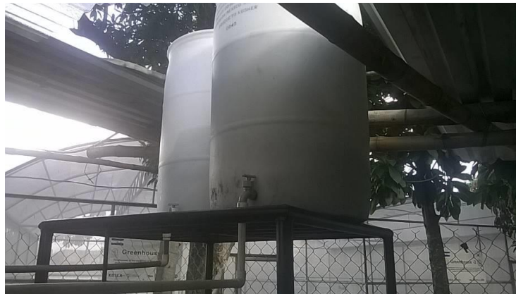
Figura A- 9. Barriles plásticos suspendidos en la torre de hierro
