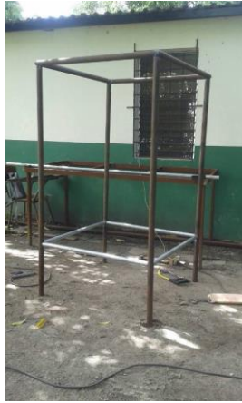
Figura A- 8. Torre de metal utilizada para la instauración del sistema de goteo
