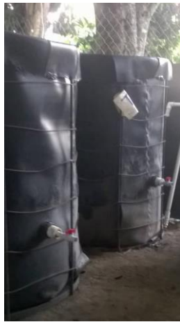
Figura A- 6. Estanques cilíndricos de geomembrana
