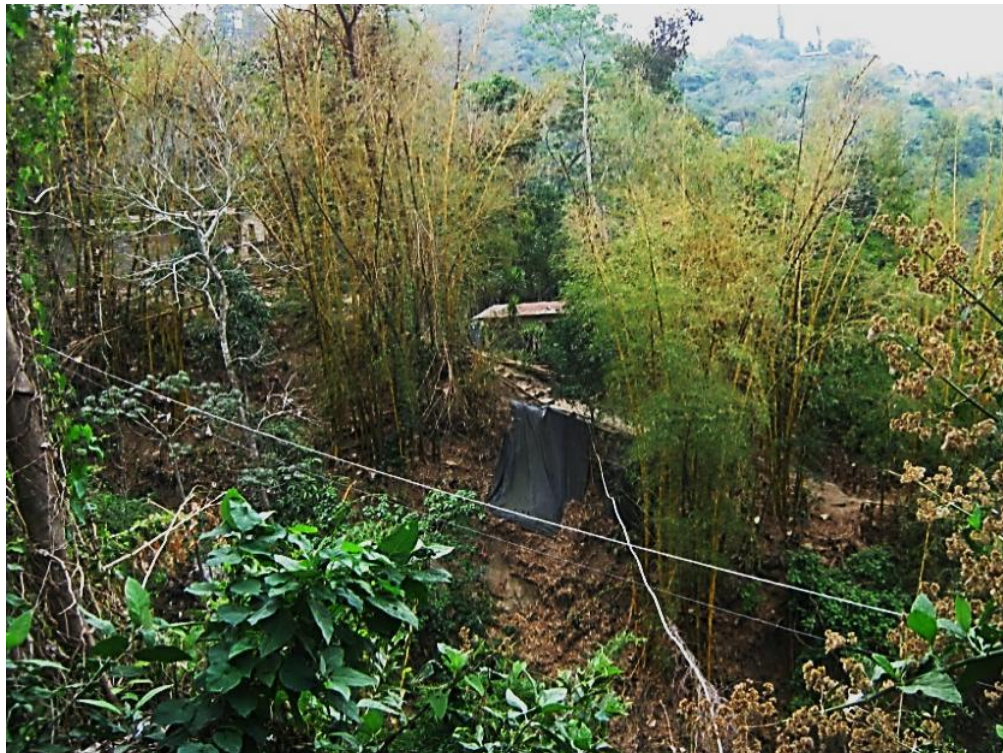
FOTOGRAFÍA 1: CÁRCAVA UBICADA EN EL PASAJE LAS VERANERAS
