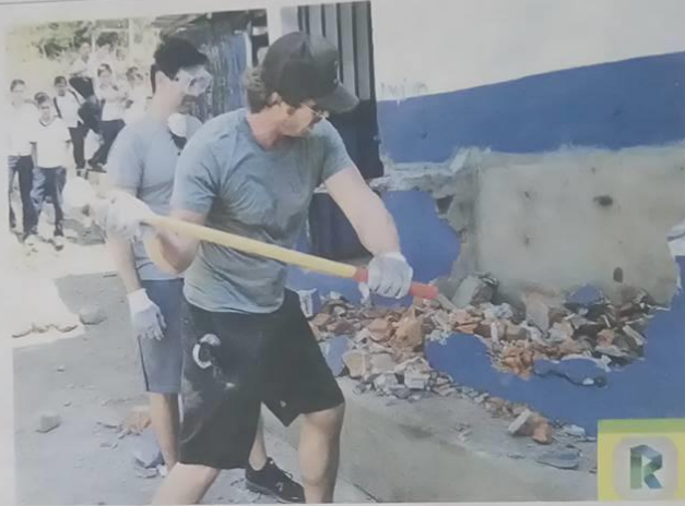
Lewis participó en la demolición y otras tareas de reconstrucción. FOTOS EDH / OMAR CARBONERO
