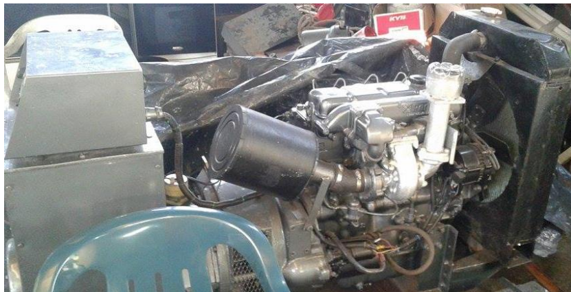
A.C.4. Generador Diésel, ya reparado.
