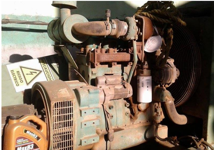
A.C.3. Generador Diesel con problemas mecánicos.
