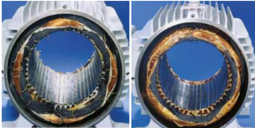
k) FALLO DE FASE CONEXIÓN EN ESTRELLA
