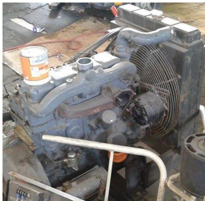
A.C.5. Generador Diésel en fase de prueba.
