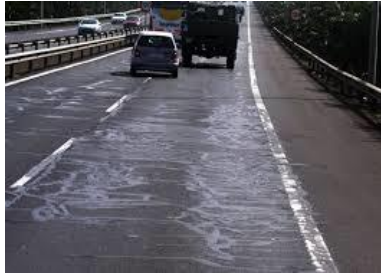
Figura 3.4 Exudación ó Afloramiento FUENTE: SIECA Manual Centroamérica de Mantenimiento de Carreteras TOMO III. Pág. 24.
