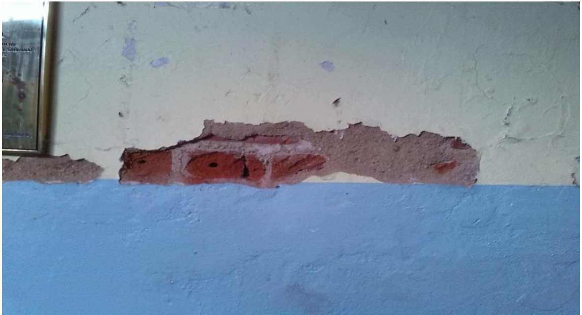
Imagen 2.3 Vulnerabilidad Estructural. Hospital Nacional San Juan de Dios de Santa Ana
