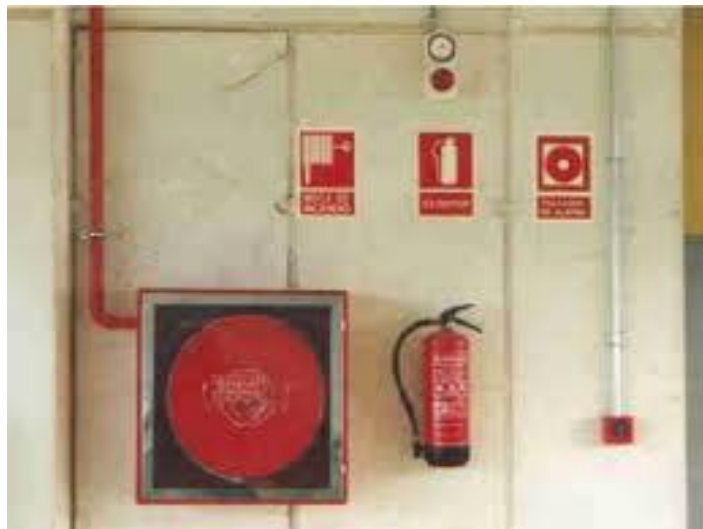
Imagen 5.8 Señalización, mangueras y extintores
