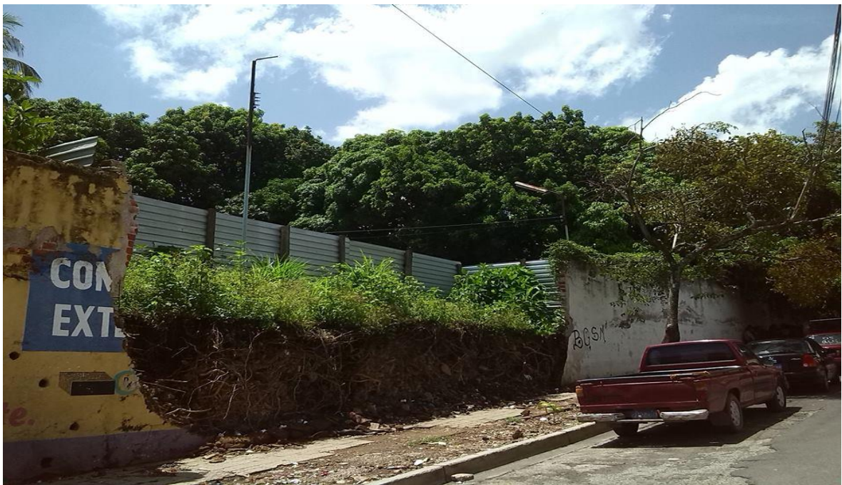
Imagen 2.4 Colapso estructural de muro perimetral. Hospital Nacional de Santa Ana
