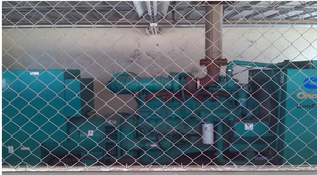
Imagen 4.14 Generador Eléctrico 325 KVA
