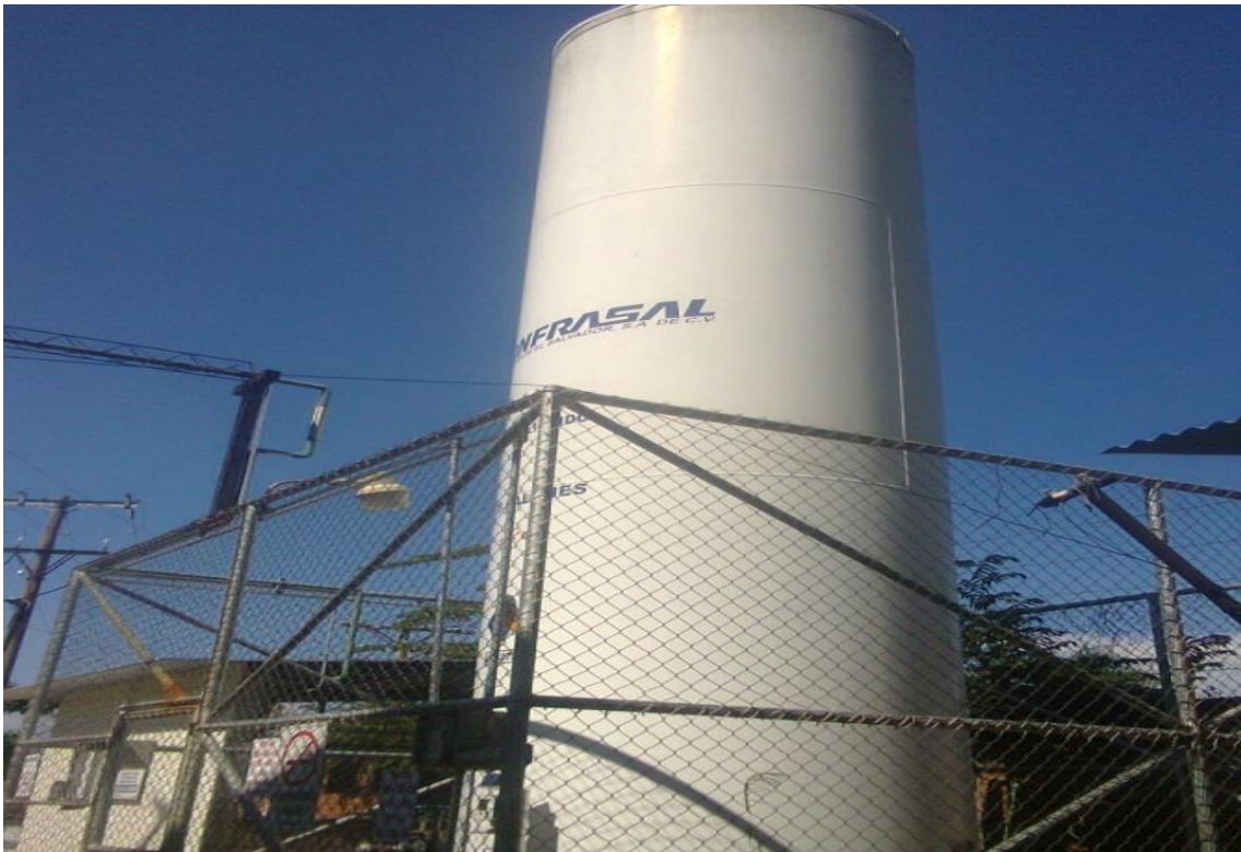
Imagen 4.21 Tanque de gases medicinales
