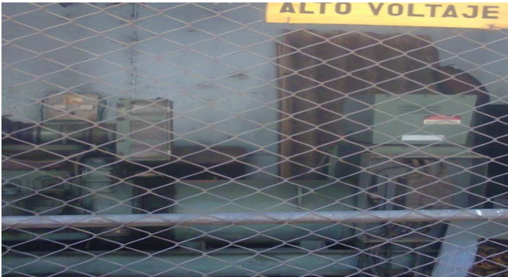
Imagen 4.15 Generador Eléctrico 225 KVA
