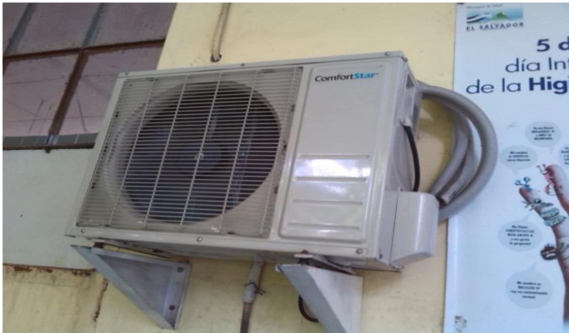
Imagen 2.6 Aire acondicionado. Hospital Nacional San Juan de Dios de Santa Ana
