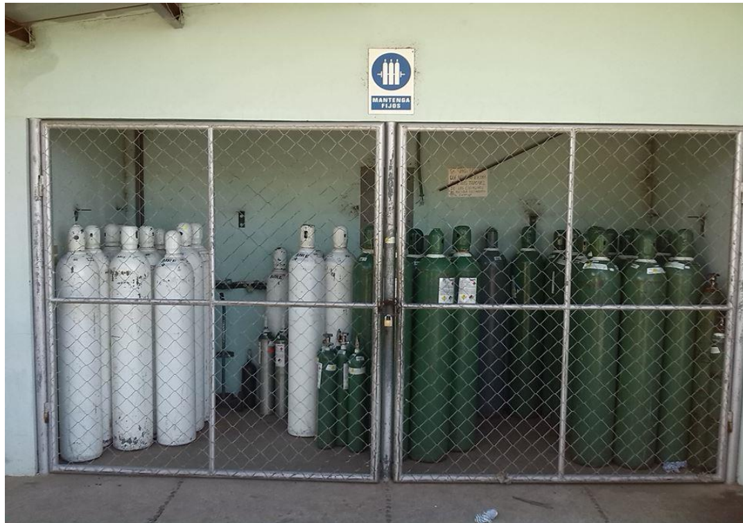
Imagen 4.22 Bodega de tanques de oxígeno
