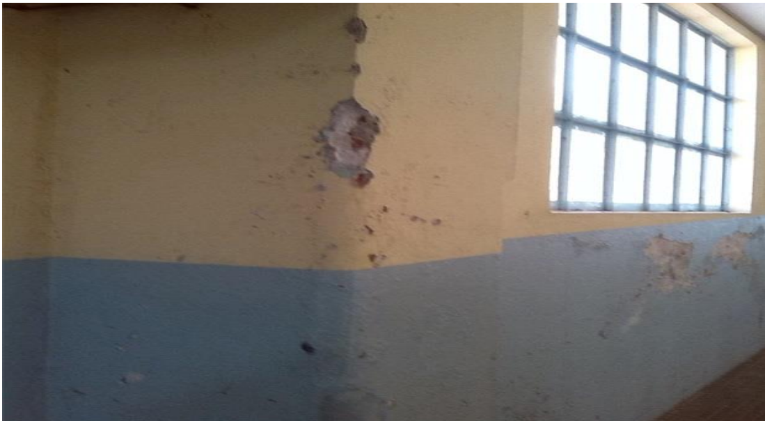
Imagen 4.13 Columna dañada por meteorización
