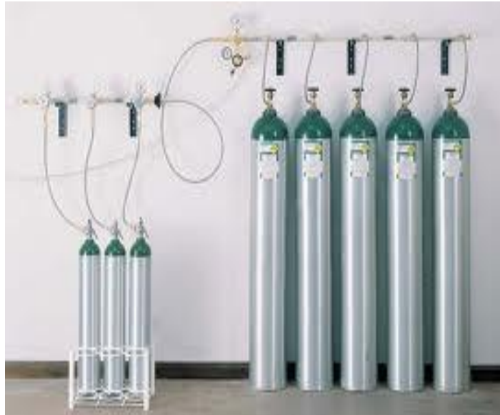
Imagen 5.3 Anclaje y válvulas de tanques de gases
