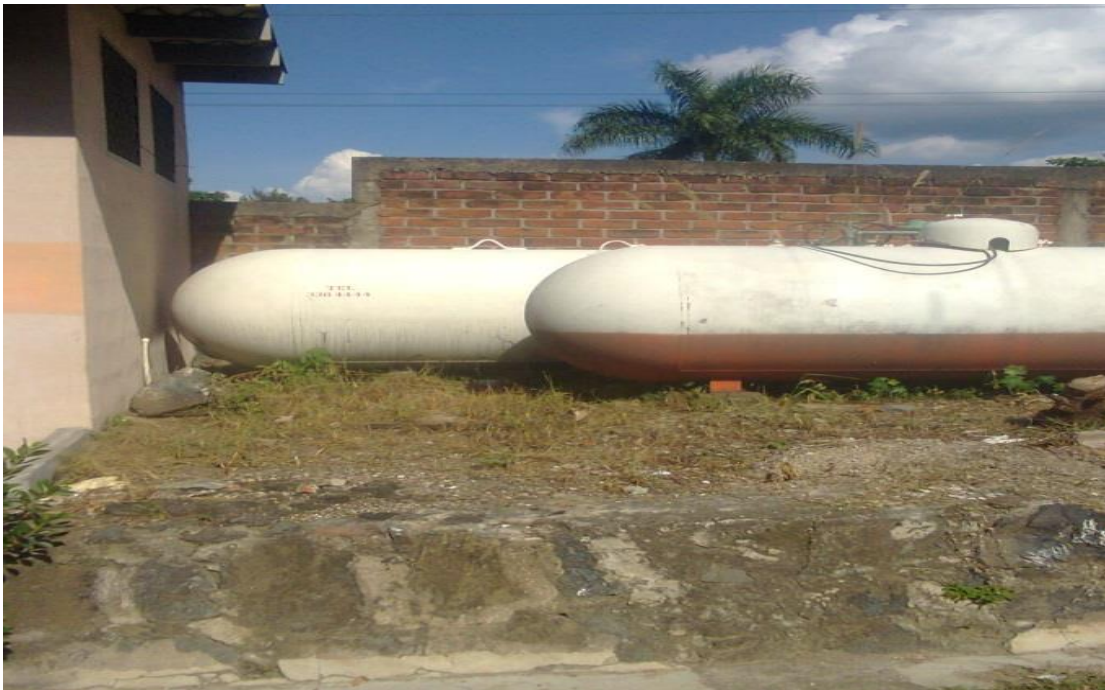
Imagen 4.20 Tanques de gas propano
