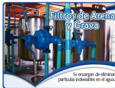
Ilustración 4 Filtros de arena y grava.
