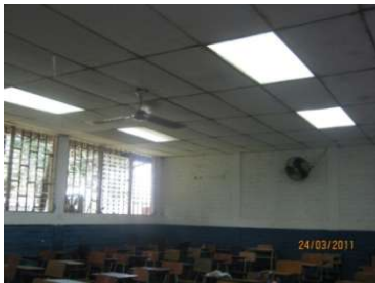
Fig. 4. 27 Iluminación de aulas del INJEAO
