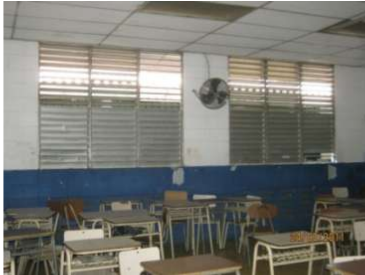
Fig. 4. 28 Ventilación de aulas del INJEAO
