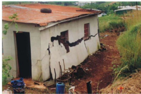
Figura No 4.11: Daños provocados a edificaciones por suelos expansivos.
