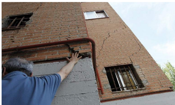
Figura No 8.4: Grietas en paredes
